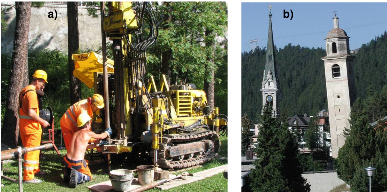
Bild 12: a) Ansicht der Bohrstelle und des Bohrgerätes, b) der Schiefe Turm von St. Moritz.
