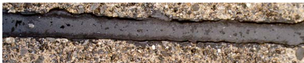
Abbildung 8.3.28: FM5. 5 Jahre nach dem Einbau. Aussehen der Fuge am Objekt. Z.T. durchgehende Flankenablösung
