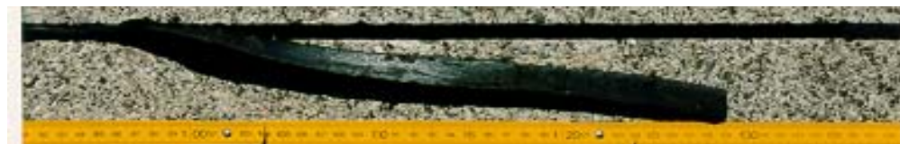
Abbildung 8.3.21: FM4. 2.5 Jahre nach dem Einbau. Aussehen der Fuge am Objekt. Z.T. durchgehende Flankenablösung
