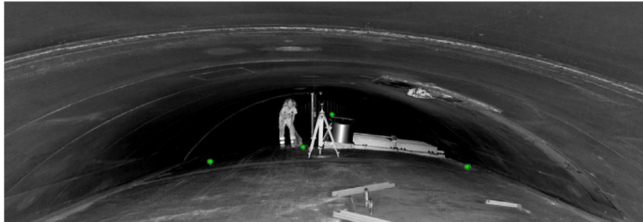
Abb. 1 Quelle: Abluftkanal Gubristtunnel 2014 (Basler & Hofmann AG)
