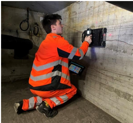
Abbildung 54: Messungen mit dem Prüfsystem Radar-2 (GP8100).
