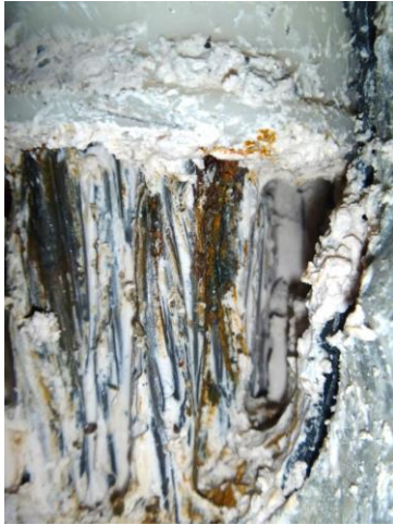
Abbildung 6: Soft-Grout bei vertikalen Spanngliedern mit starker Korrosion des Spannstahls
