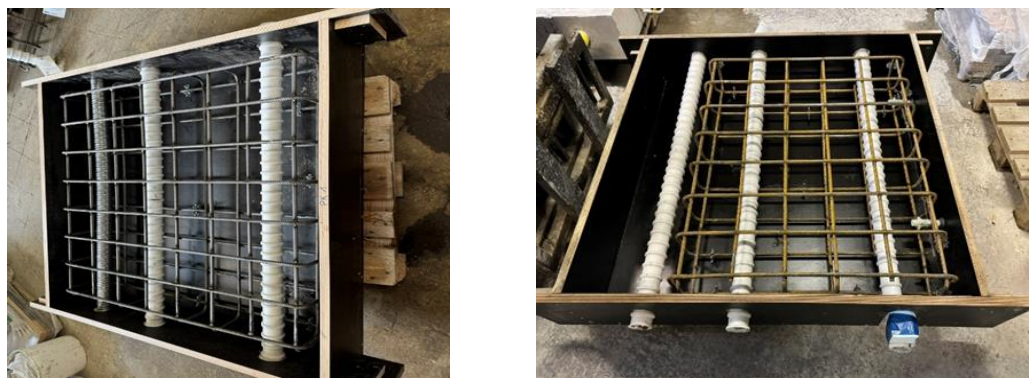
Abbildung 20: Schalung der Prüfkörper Uno (links) und Dos (rechts) mit Bewehrung und Spanngliedern.
