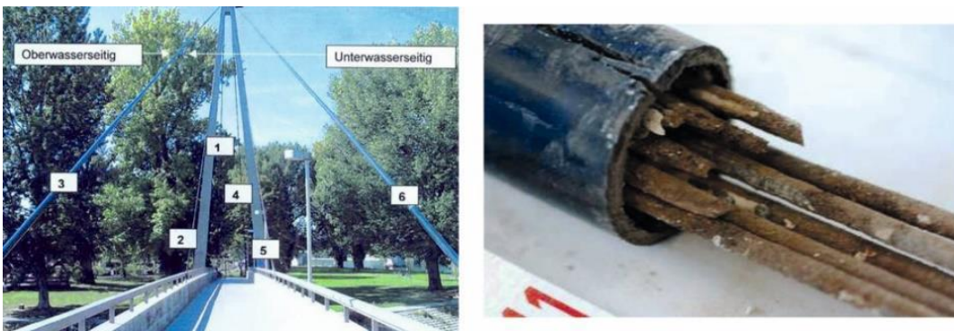
Abbildung 3: Birskopfsteg, Basel/Birsfelden. Längsriß im Hüllrohr und Korrosion an den darunter liegenden Spanndrähten bei den Schrägseilen. Bruch eines Schrägseils unterhalb der oberen Verankerung am 22.6.2007 ohne Einsturz der Brücke. Gesamter Restquerschnitt vor dem Bruch: ca. 42 % [8]
