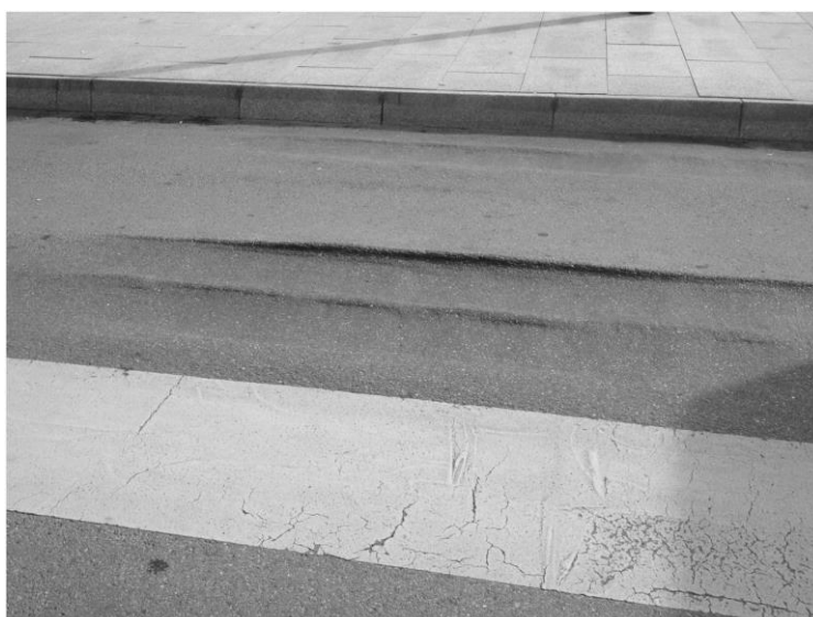
Fig. 121 Orniérage marqué au droit d'un arrêt de bus.
