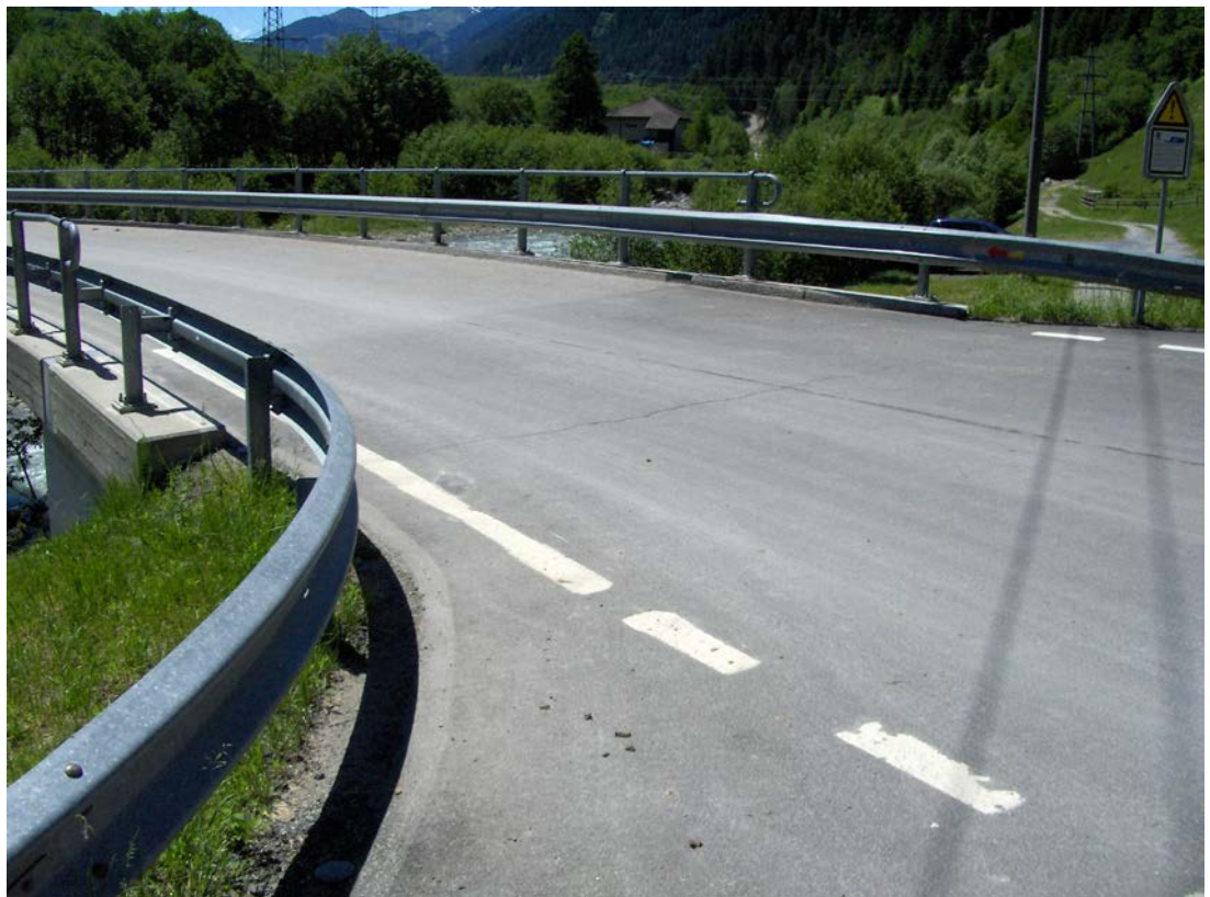
Abb. 28 Foto aus dem Jahre 2005 mit Belagsschäden linkes Brückenende Vorderrheinbrücke, Cumpadials (GR)
