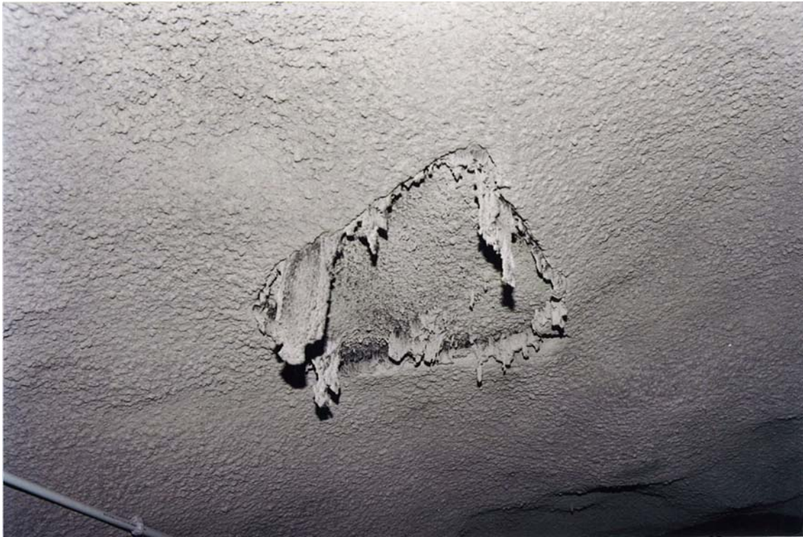
Foto 928/5: Abplatzungen infolge unzureichender Haftung der Abdichtung
