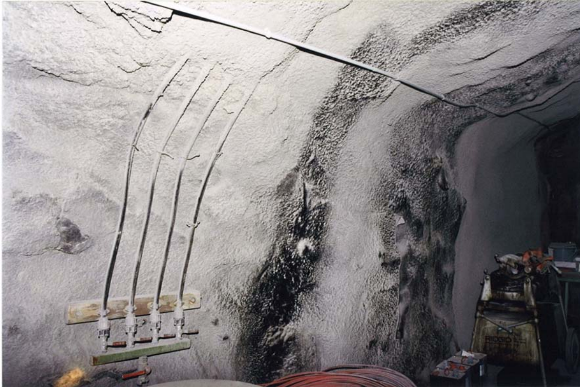
Foto 928/3: Schlauchanschluss für Wasservermessung
