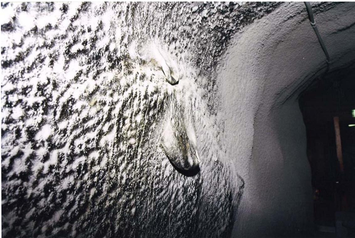
Foto 928/4: Gespritzte Bitumenabdichtung mit Blasenbildung
