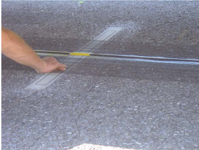
Abb. 4.31 Installierter WIM Sensor
