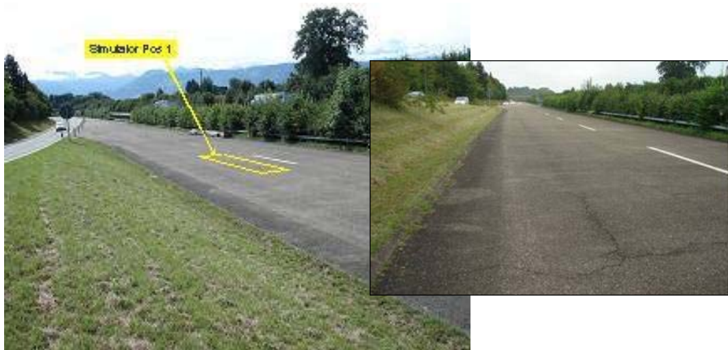
Abb. 4.23 Situation Anschlussstück mit Position 1 der ersten Prüfung und typischen Rissen
