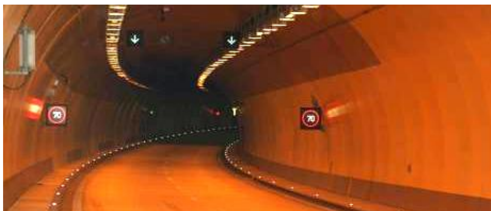
Abbildung 12: Randstein-LED-Beleuchtung mit Lauflichtfunktion im Tunnel Markusberg 19
