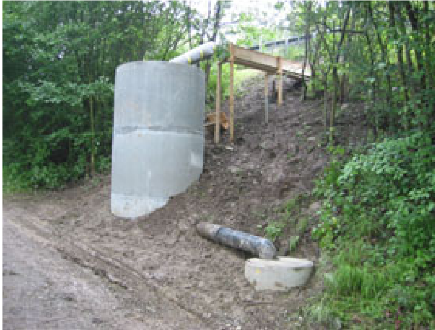
Abbildung 1: Der Filterschacht mit der Zuleitung von der Autobahn A6 und der Ableitung in eine bestehende Entwässerungsleitung.
