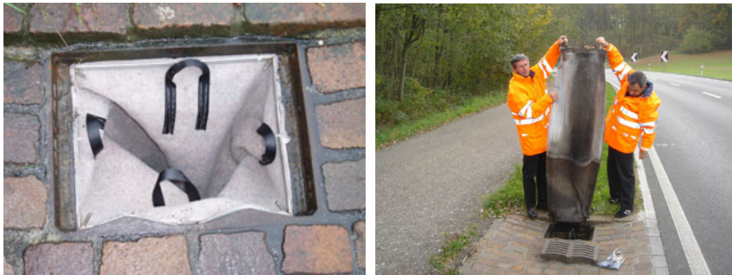
Abbildung 40: a) Pilotversuch an der Kantonsstrasse Kloten – Lufingen: der frisch eingesetzte Geotextilsack und b) der Sack lässt sich nach einigen Wochen Betrieb einfach aus dem Schlammsammler herausnehmen.
