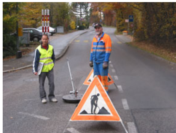
Abbildung 105: Funktionskontrolle durch Roland Spälti und Peter Moser. Schächte in der Strassenmitte sind aus der Sicht des Unterhalts nicht zu empfehlen.
