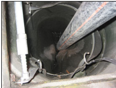
Abbildung 166: Mit dem Saugrohr wird der Schlamm aus dem unteren Teil des Sacks herausgesogen.
