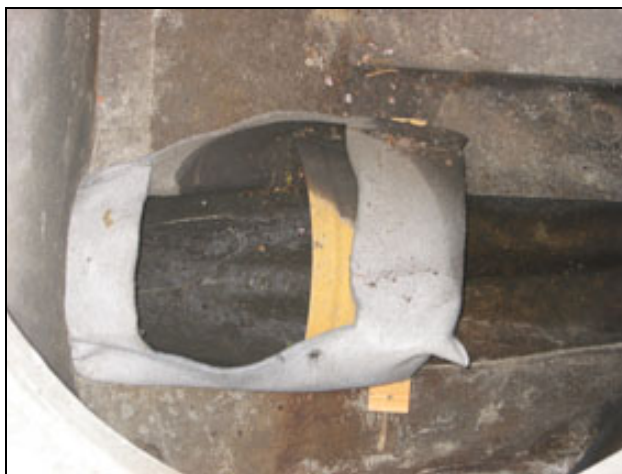
Abbildung 35: Horizontal eingebauter Sack in einen Kanalisationsschacht in der Muhlerstrasse in Köniz. Im Sack ist schwarzer Strassenschlamm gut sichtbar. Bei starken Regen wurde der Schlamm permanent ausgewaschen.
