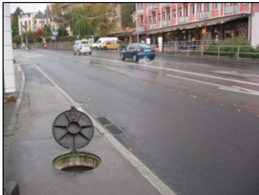
Abbildung 23: Avenue de Lavaux in Pully. Das Strassenabwasser wird vom Strassen-Einlaufschacht in den Filterschacht geleitet.
