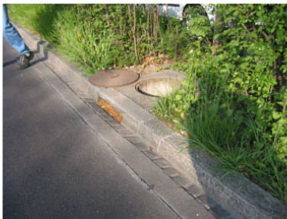
Abbildung 81: Durch den seitlichen Einlaufschlitz fließt das Wasser in den Strassensammler, in dem sich der Geotextilsack befindet.
