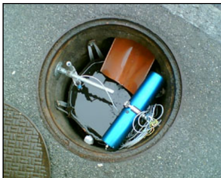
Abbildung 140: Die Installation Lavaux 50. Für die Registrierung des Wasserspiegels wurde ein Messgerät eingebaut.
