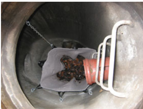
Abbildung 104: Der Kontrollschacht mit der oben in den Schacht einmündenden Strassenentwässerungsleitung. Unten der eingehängte Geotextilsack.
