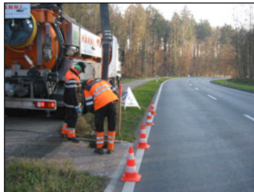
Abbildung 161: Die Einlaufschächte befinden sich ausserhalb der Fahrspuren.
