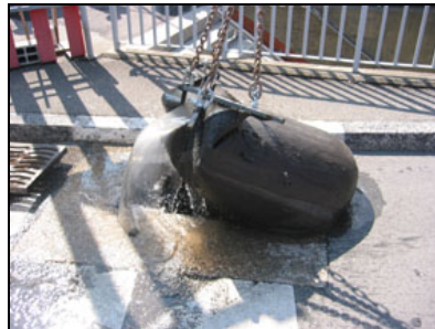
Abbildung 152: Um den Entleerungsvorgang zu beschleunigen wird der Sack auf den Boden gestellt. Das über dem Schlamm stehende Wasser fließt aus.
