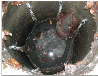
Abbildung 21: Versickerungsschacht mit eingehängtem Geotextilsack. Nach dem Gewitterregen ist der Sack mit Strassenabwasser gefüllt.
