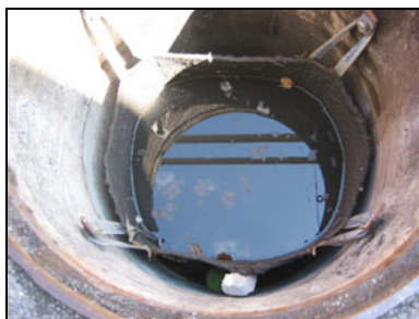
Abbildung 144: Schacht mit eingehängtem Geotextilsack.
