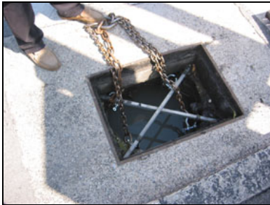
Abbildung 148: Der Sack ist im Einlaufschacht an einem Metallkreuz aufgehängt.
