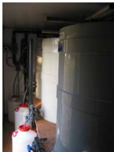
Abbildung 7: Die drei Filterkolonne ist mit je 1m Durchmesser. Jede Filterkolonne ist mit einem Geotextilsack ausgerüstet. Zur Ermittlung der Reinigungsleistung wurden mengenproportionale Abwasserproben als Sammelproben entnommen.
