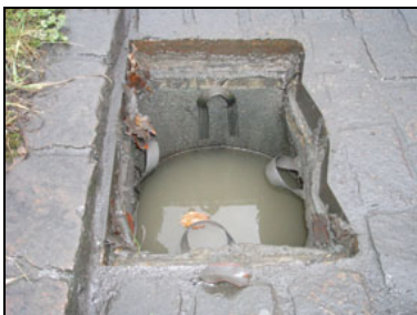
Abbildung 167: Schacht mit eingehängtem Geotextilsack. Nach Regenfällen ist der Sack mit Abwasser gefüllt.
