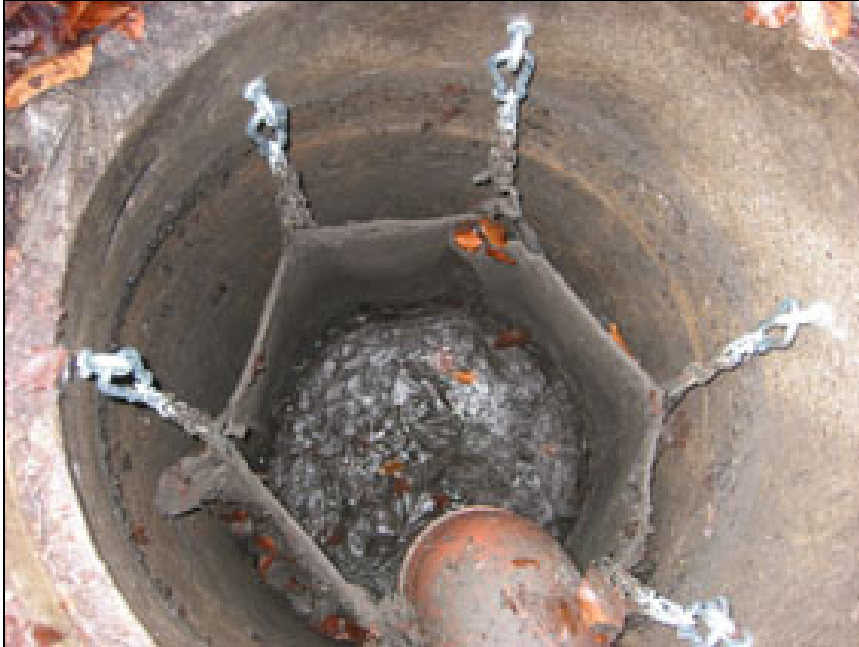
Abbildung 36: Einer der beiden Versickerungsschächte mit dem Geotextilsack im Bremgartenwald neben der Bremgartenstrasse in Bern
