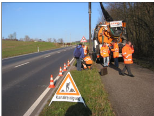
Abbildung 160: Die Lufingerstrasse hat ein Quergefälle. Das Abwasser fliesst längs des Strassenrandes in die Einlaufschächte.
