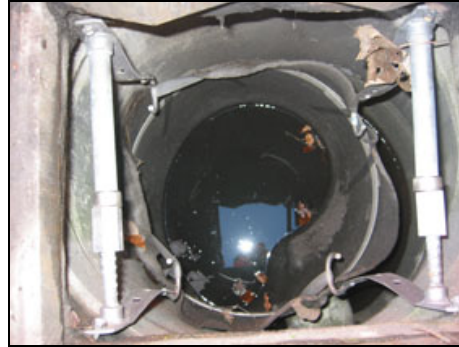
Abbildung 164: Einer der 3 Einlaufschächte mit einem Geotextilsack.
