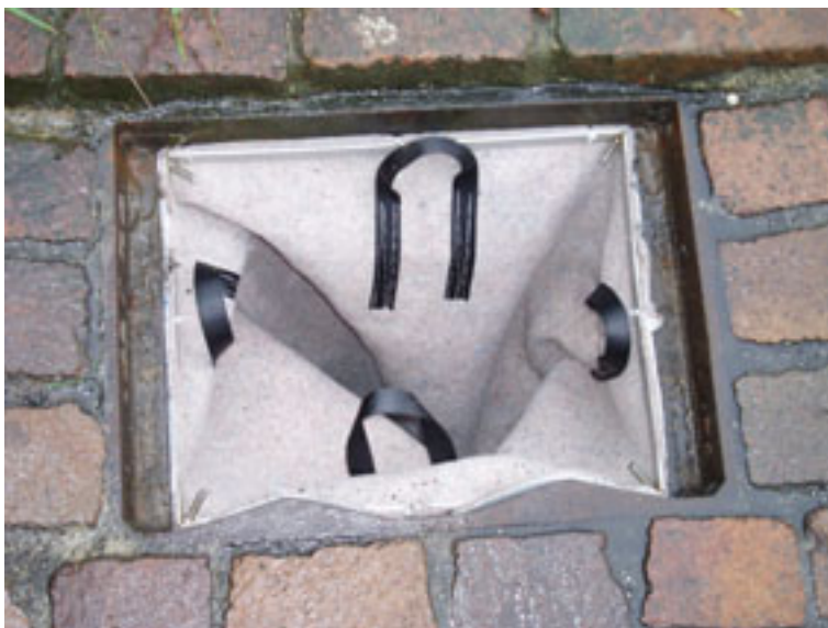
Abbildung 14: Schlammensammler mit neuem Geotextilfiltersack auf der Lufingerstrasse bei Kloten.
