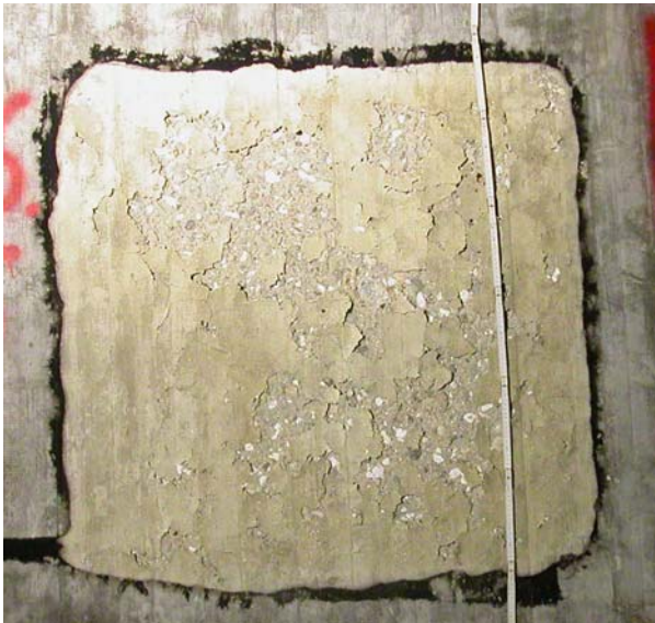
Abbildung 22: Prüfkörper Mix 3 mit d=350 mm nach der Brandprüfung
