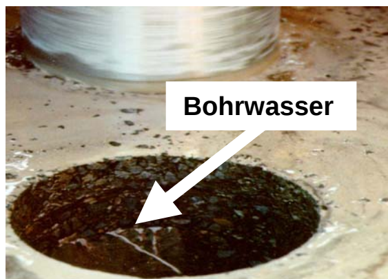
Abbildung 3.3.2: Eindringen von Bohrwasser zwischen die Schichten
