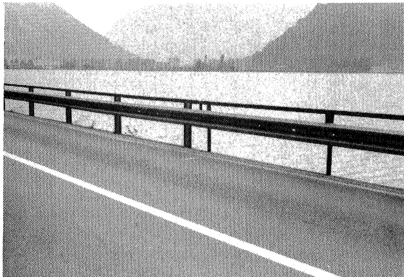
Abb. 5-21, Gewässer neben der Strasse mit einer Wassertiefe über 1 m
