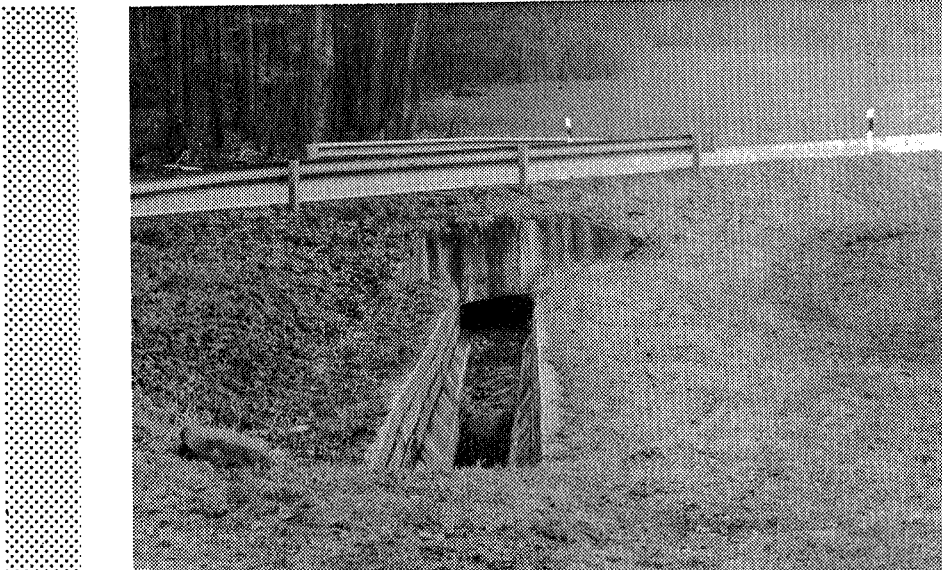
Abb. 5-22, Kurzer offener Gewässerlauf, der eingedolt werden sollte
