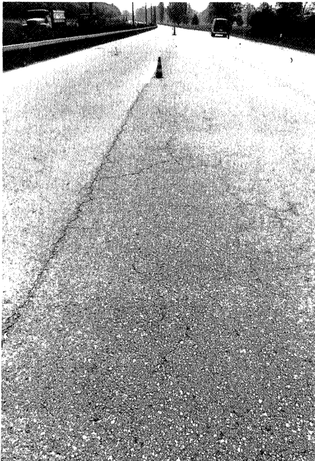
Abb. 17: Gerissene Arbeits- naht zwischen Fahr- und Ueberholstreifen
