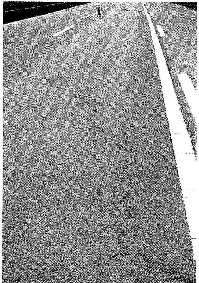
Abb. 18: Gerissener Randbereich des Fahrstreifens
