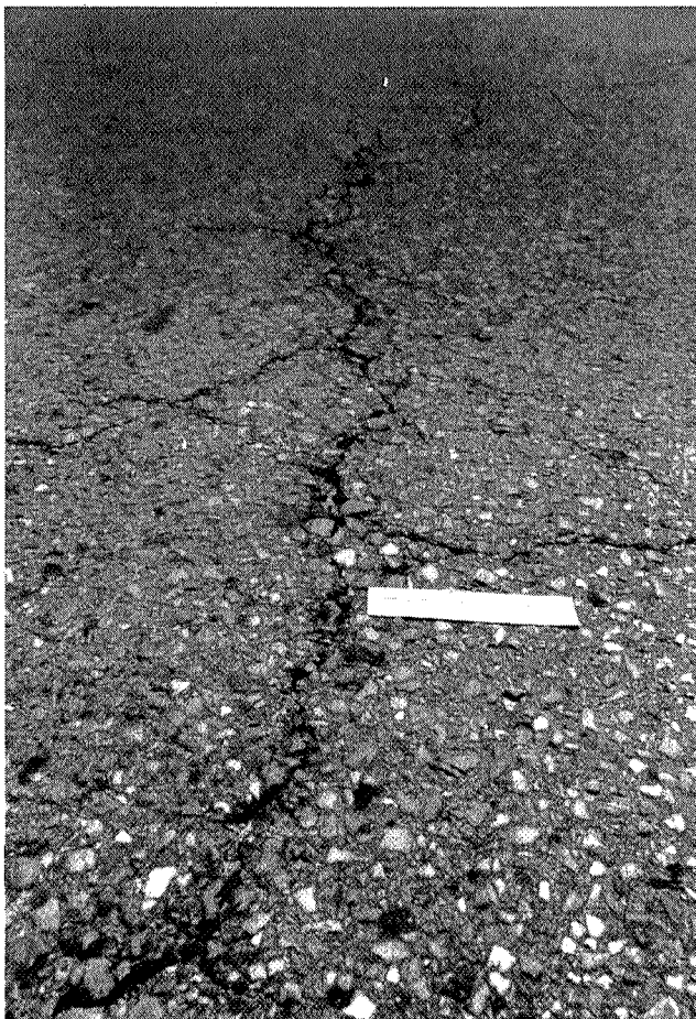
Abb. 20: Längsriss mit Ver- ästelungen
