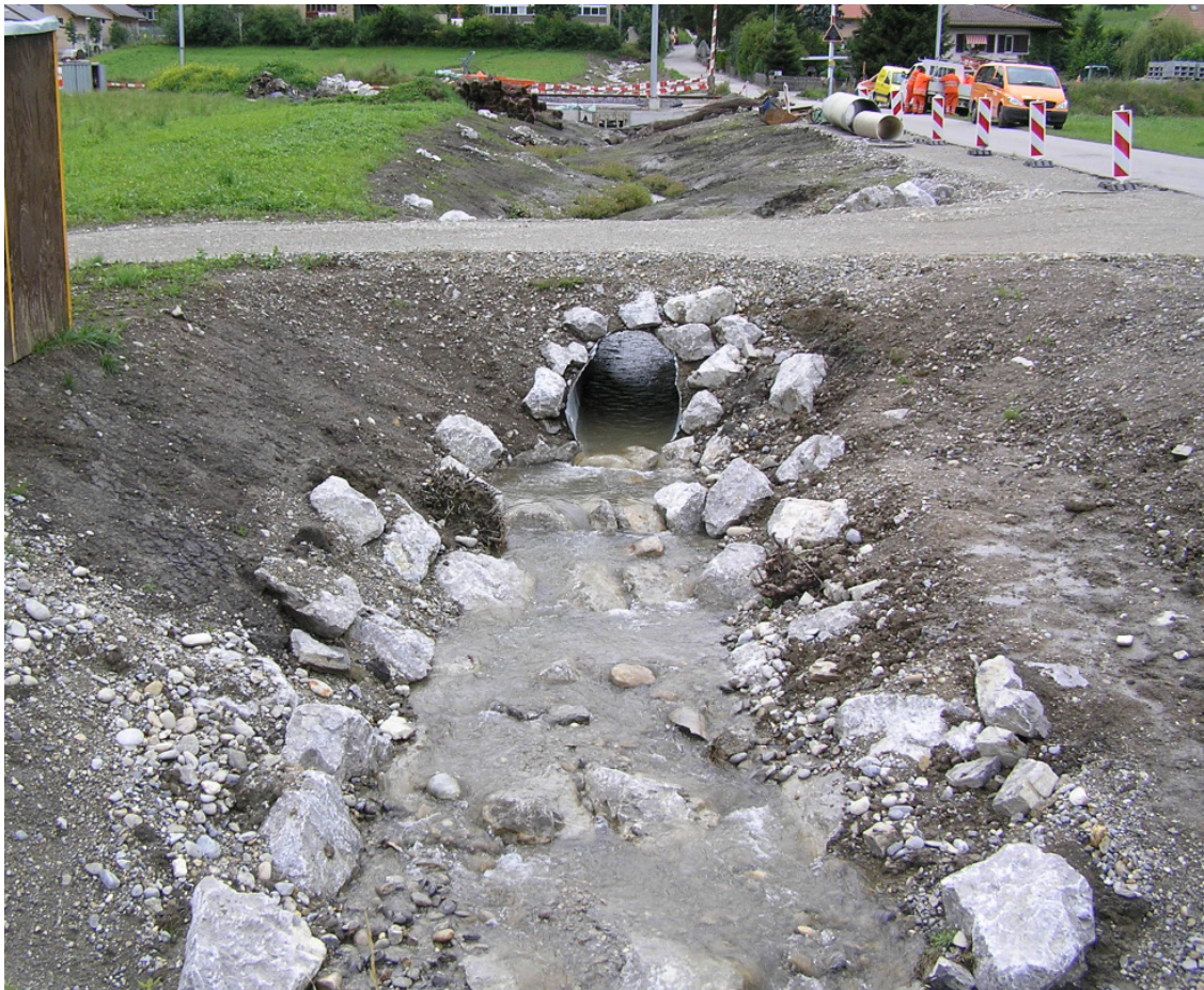
Abbildung 18: Durchlass mit Blockrampe unterhalb des Gutenbrünnenbachs im Gürbetal (Foto Th. Vuille). Der Gewässerdurchlass weist dank der Rampe eine durchgehende Natursohle auf, wobei die oberste Blockreihe etwas zu nahe am Durchlass befestigt wurde
