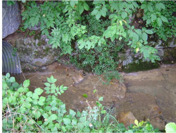
Abbildung 7: Mit Steinen verbautes Ufer unterhalb des Durchlass
