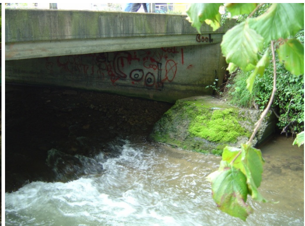
Abbildung 42: Durchlass mit teilweise vorhandenem Bankett
