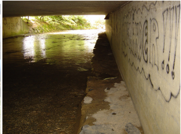
Abbildung 36: Vorhandenes, z.T. etwas ausgeschwemmtes Bankett
