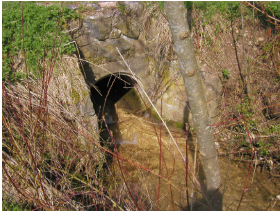
Abbildung 2: Durchlass der Sissle bei Frick, der wahrscheinlich weder für terrestrische noch für aquatische Tiergruppen durchgängig ist
