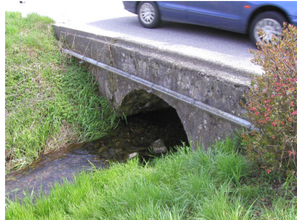
Abbildung 3: Bach bei Rohr, bei welchem terrestrische Tierarten zur Überquerung des Engpasses auf die Strasse ausweichen
