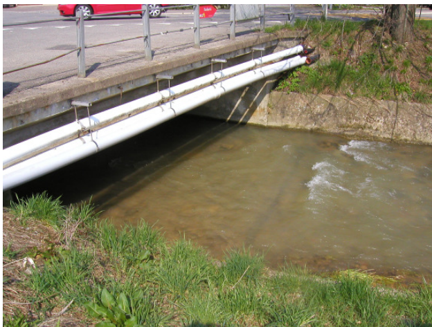
Abbildung 1: Für terrestrische Tierarten entlang des Gewässers unüberwindbarer Durchlass, Bruggbach bei Oberfrick (wenn nichts anderes vermerkt wird sind die Fotos von der Verfasserin des Berichts J. Müller, PiU GmbH)
