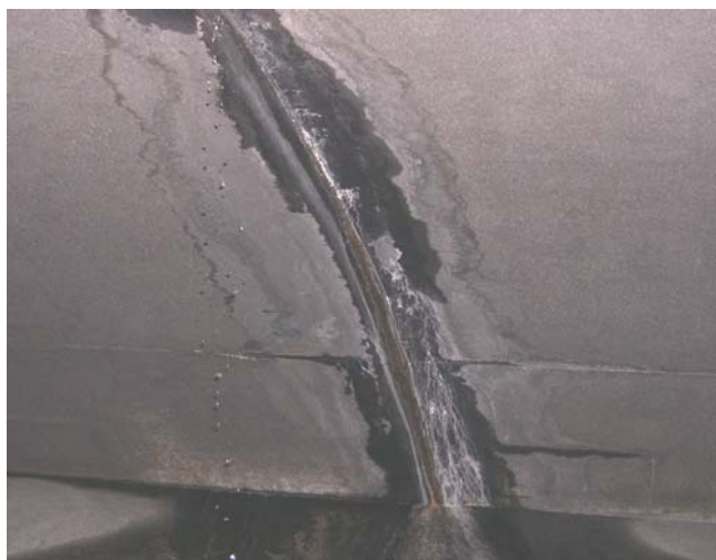
Abbildung 11 - Wassereintrittsstelle mit fliessendem Wasser aus Blockfuge (Klassifikation FK 3)
