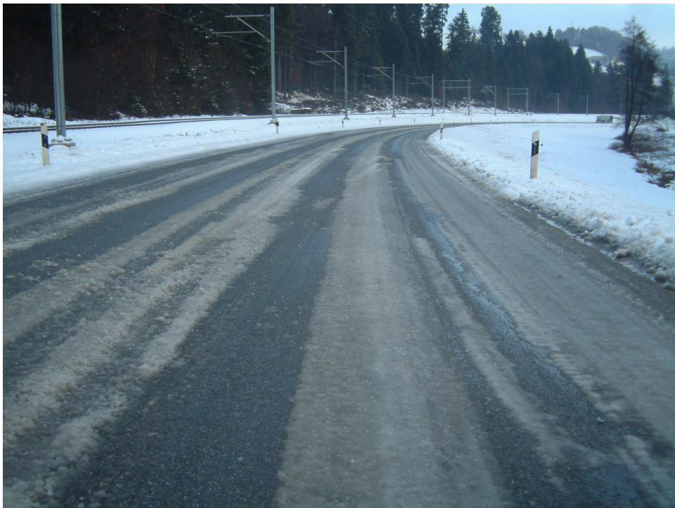
Abbildung 8-8: Zustand der gleichen Kantonsstrasse gleich angrenzend im benachbarten Kanton ohne WMS und zentraler Alarmierung am 31.12.2005 (10.51 Uhr)
