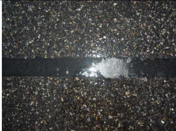
4. Feuchtigkeitssensoren: Fugen In Ordnung
