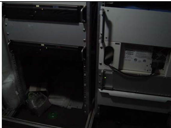
8. Elektroschrank: Kein Wasser keine Schäden
