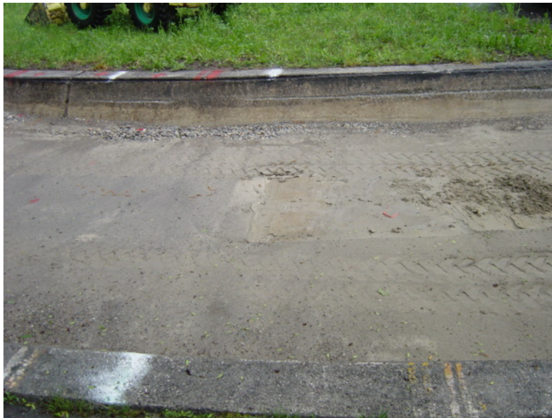
Bild 75 Verstopfung der Drainage (Feld4)
