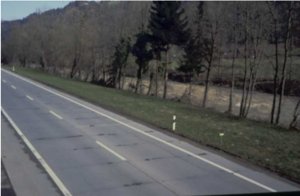
Abbildung 6.4: T10 Umfahrung Malters, Gesamtbild der Fugenschäden 1981.
