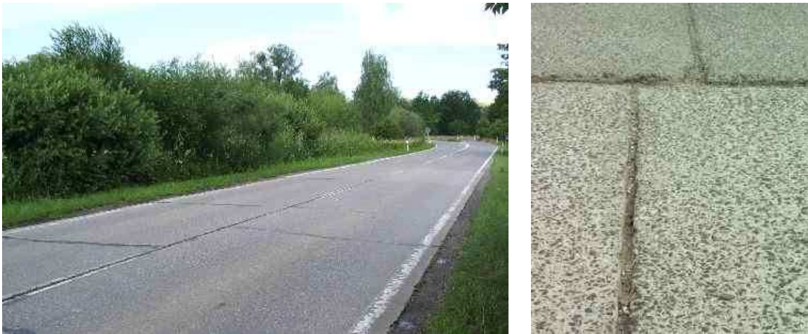
Abbildung 3.3: Lange Platten durch Querrisse entspannt (links) und typische Vibrierfugen (rechts)
