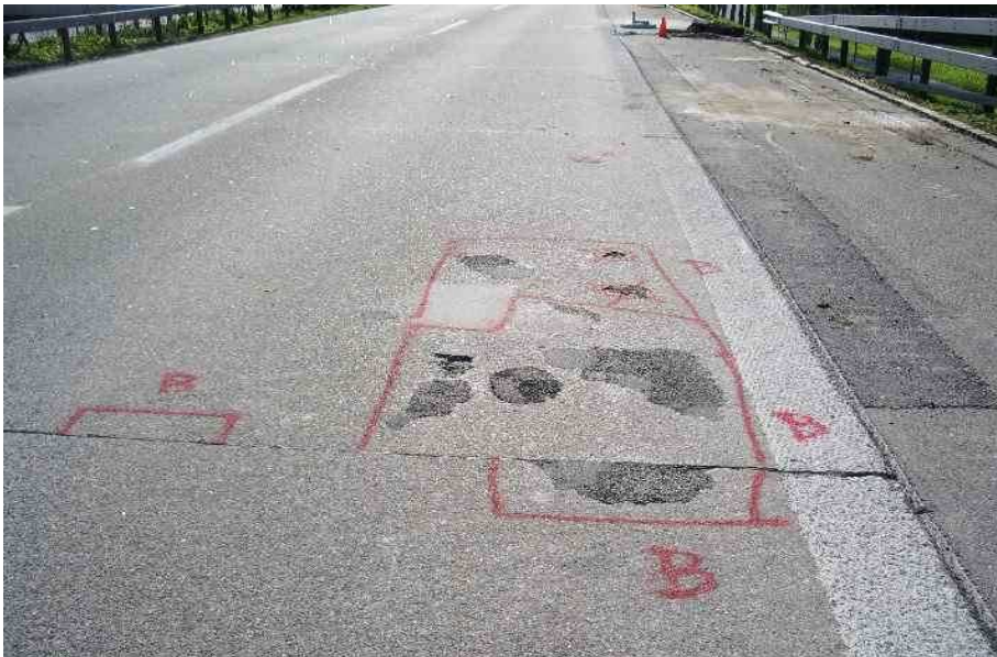
Abbildung 3.1: Kanten- und Oberflächenschäden
