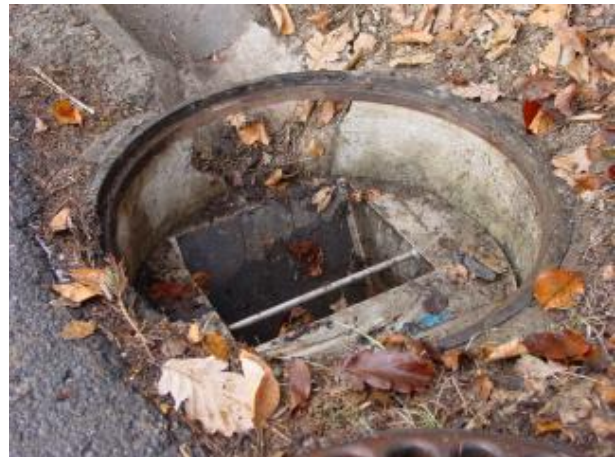
Amphibiensyphon im Ablauf montiert.
