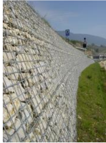
A5 Autobahn Yverdon-les-Bains - Neuchâtel, Seeseitige Ausfahrtsrampe in Vaumarcus. Foto: Sytec Bausysteme AG
