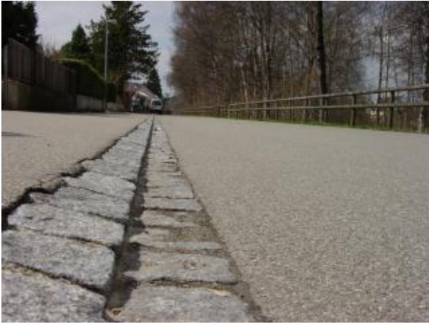
In Quartierstrassen genügen oft auch solche flache Randabschlüsse.
