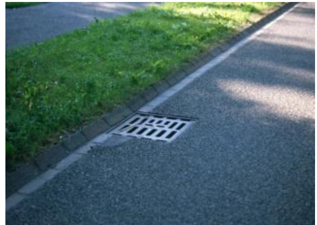
Im Bereich von Einläufen der Strassenentwässerung ist ein schräger Randabschluss besonders wichtig. Foto: Oekovision GmbH, 8967 Widen
