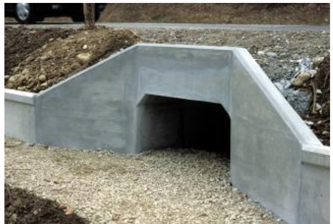
Ein Kleintiertunnel mit Kastenprofil. Foto: Oekovision GmbH, 8967 Widen
