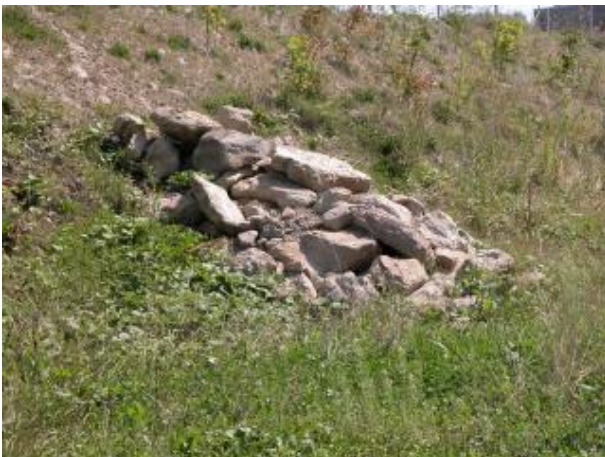
Steinlinse an Böschung
