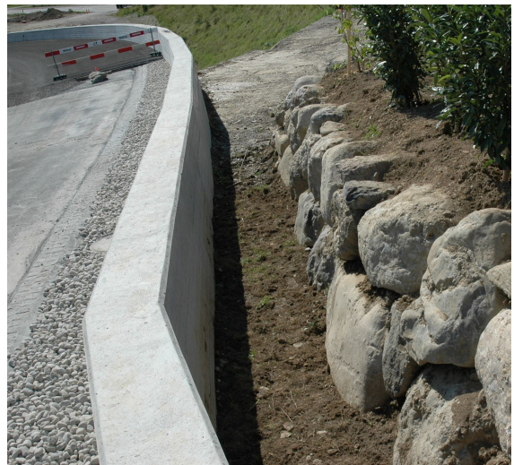
Abbildung 4: Stützbauwerke wie diese Betonmauer links im Bild stellen für manche Kleinsäuger eine unüberwindbare Barriere dar.
