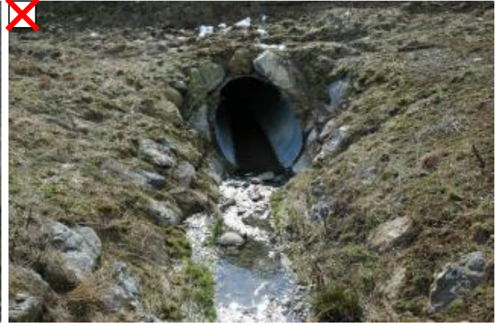
Schlechtes Beispiel eines Gewässerdurchlasses.
