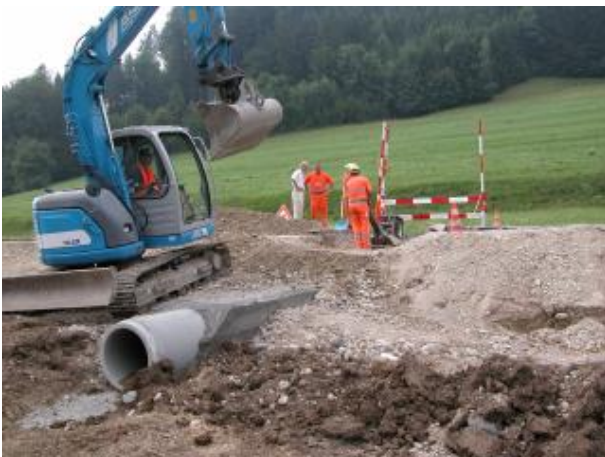
Beim Neubau von Strassen stellen Kleintierdurchlässe einen verhältnismässig kleinen Budgetposten dar und sollten standardmässig eingebaut werden.
