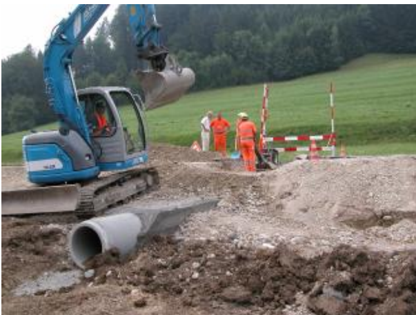
Beim Neubau von Strassen stellen Kleintierdurchlässe einen verhältnismässig kleinen Budgetposten dar und sollten standardmässig eingebaut werden.
