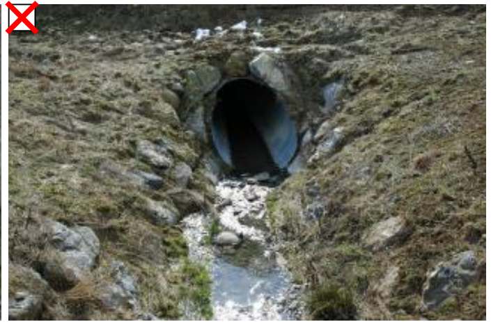
Schlechtes Beispiel eines Gewässerdurchlasses.
