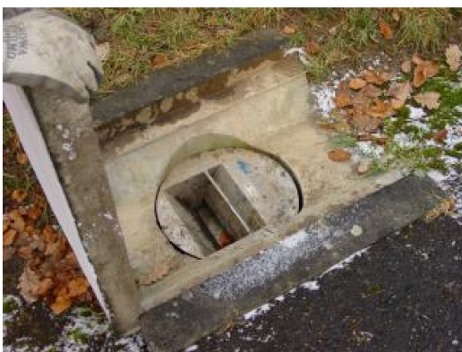
Amphibiensyphon im Ablauf montiert.
