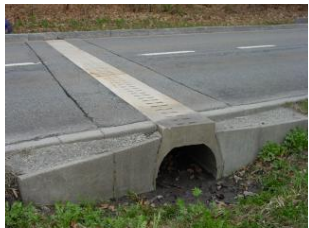
Aco-System: Wenn aus technischen Gründen nicht tief gegraben werden kann, so ist diese Methode oft die einzig mögliche Lösung.
