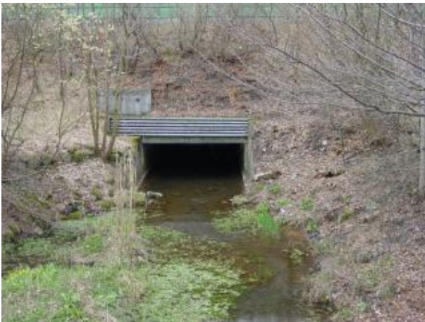
Ein Gewässerdurchlass mit natürlicher Sohle aber ohne Berme für Wildtiere.
