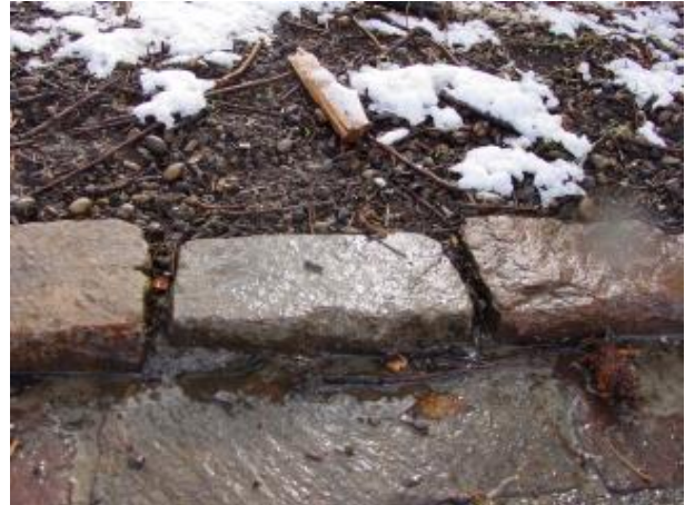
.. aber auch kleine Spalten eröffnen Kleintieren Möglichkeiten zum Verlassen der Fahrbahn.
