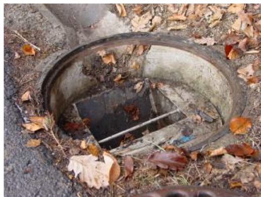
Amphibiensyphon im Ablauf montiert.
