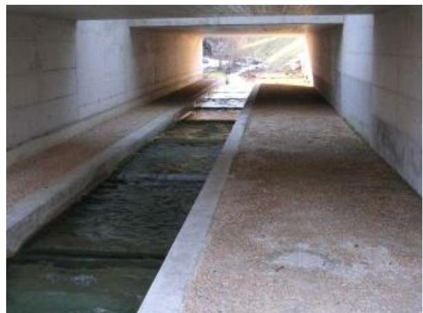
Dieser Kanal musste aus Gründen der Hochwassersicherheit gerade gehalten werden. Die niedrigen Schwellen sind aber so angelegt, dass eine vielfältige Strömung entsteht, und ein Lichtschacht erhellt den Durchlass.
