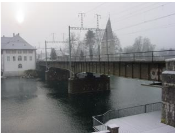
Eisenbahnbrücke in Solothurn West. Um zu verhindern, dass Wasservögel mit der Oberleitung kollidieren, wurden kleine Plastikspiralen aufgehängt.
