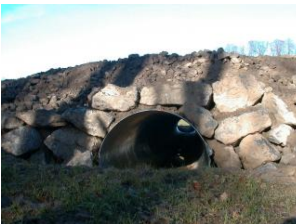
Ein Kleintierdurchlass mit Röhrenprofil. Die meisten Durchlässe werden heute aber mit Kastenprofilen erstellt.
