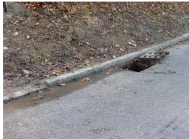
Dieser Schacht fängt jedes Jahr unzählige Amphibien, obwohl der Bordstein sehr niedrig und z.T. sogar abgeflacht ist. Eine Ausstiegshilfe ist deshalb unabdingbar.
