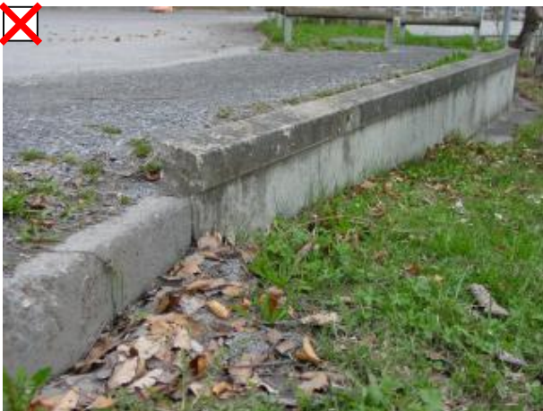
Ungenügende Ausführung. Das Leitwerk sollte vollständig durchgezogen werden, mit Überkletterschutz, korrekter Höhe, etc.
