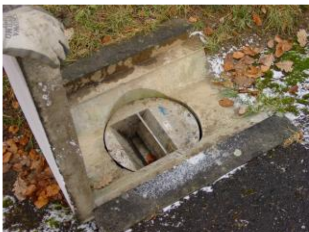
Amphibiensyphon im Ablauf montiert.
