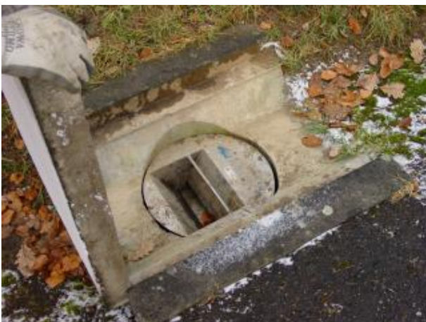
Amphibiensyphon im Ablauf montiert.
