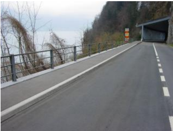
Dieser Randstein bei Bauen (UR) führt Amphibien direkt in den Tunnel, statt zu den Laichplätzen am Seeufer.
