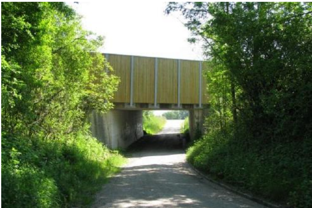
Abb. 11 Multifunktional genutzte Unterführung mit Blendschutz aus Holz, um den Flugkorridor im Dunkeln zu halten. Aus Lugon A., Eicher C., Bontadina F. (2017) [50].
