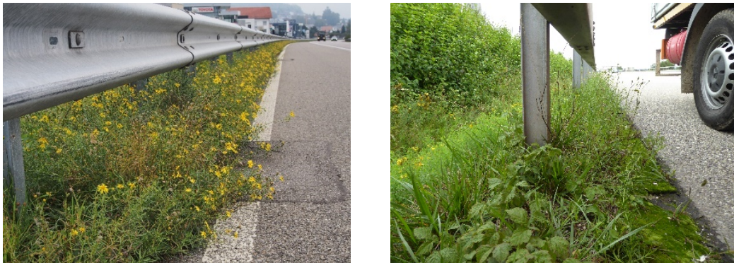
Abb. 39 Typische Probleme im Bereich der Leitplanke.
