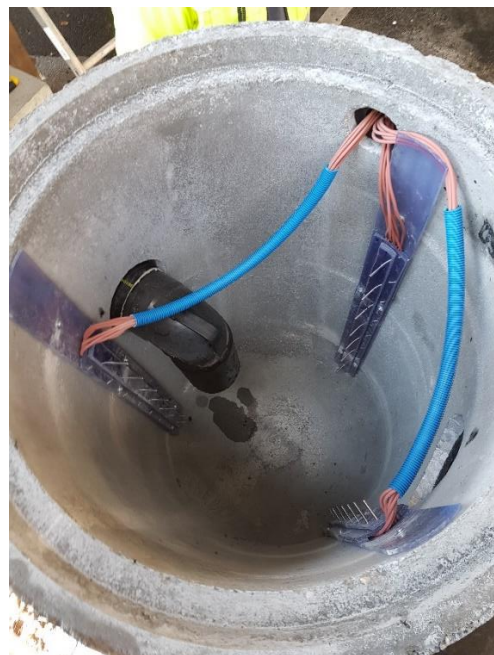
Abb. 8: Temperatursensoren im Schlammsammler
