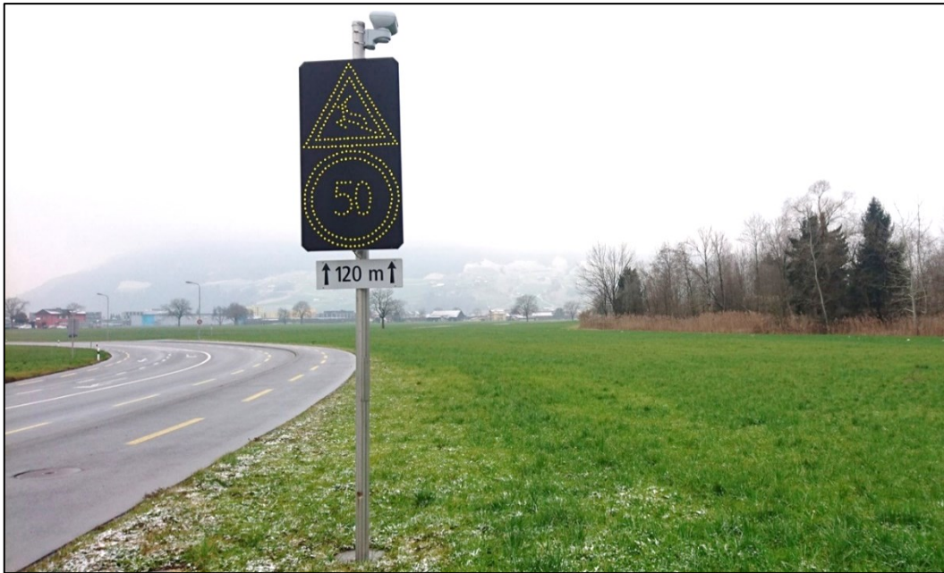
Abb. 23: Wildwarnanlage mit Erfassungssensor und einer Handlungsanleitung für Verkehrsteilnehmer. © WLS.CH
