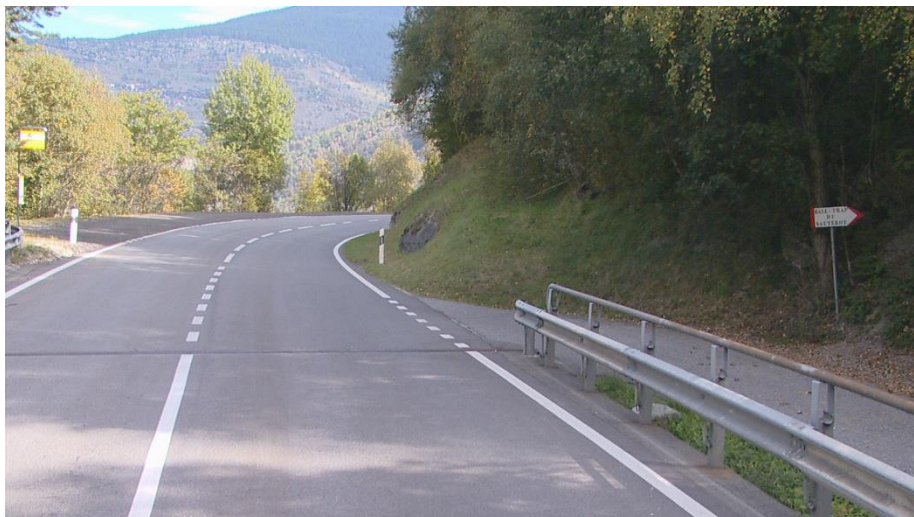
Fig. 43 Vue du défaut ponctuel (joint de pont) sur le tronçon 1
