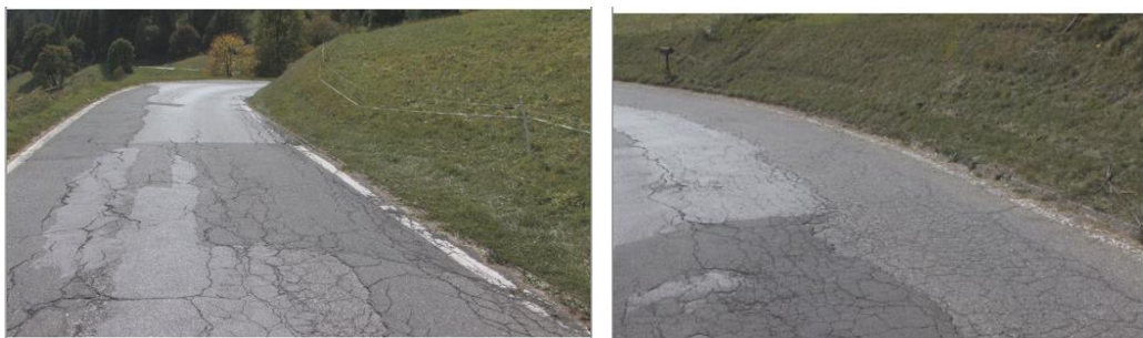
Fig. 54 Surface avec les dégradations très avancé (tronçon 5)
