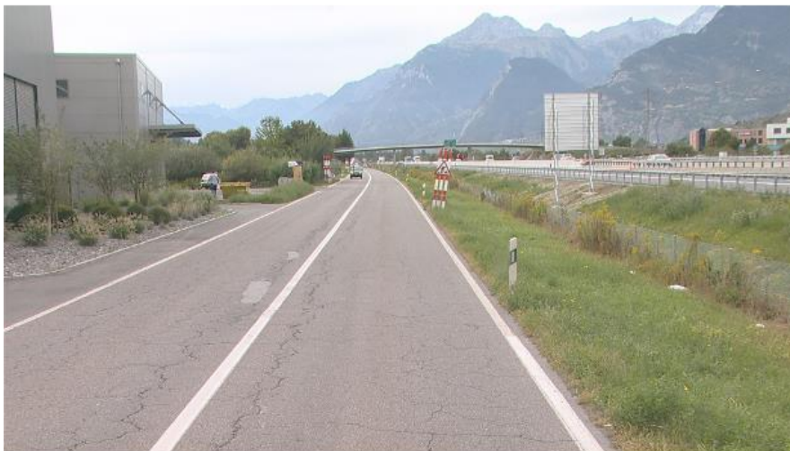
Fig. 52 Présence des fissures sur le tronçon 4
