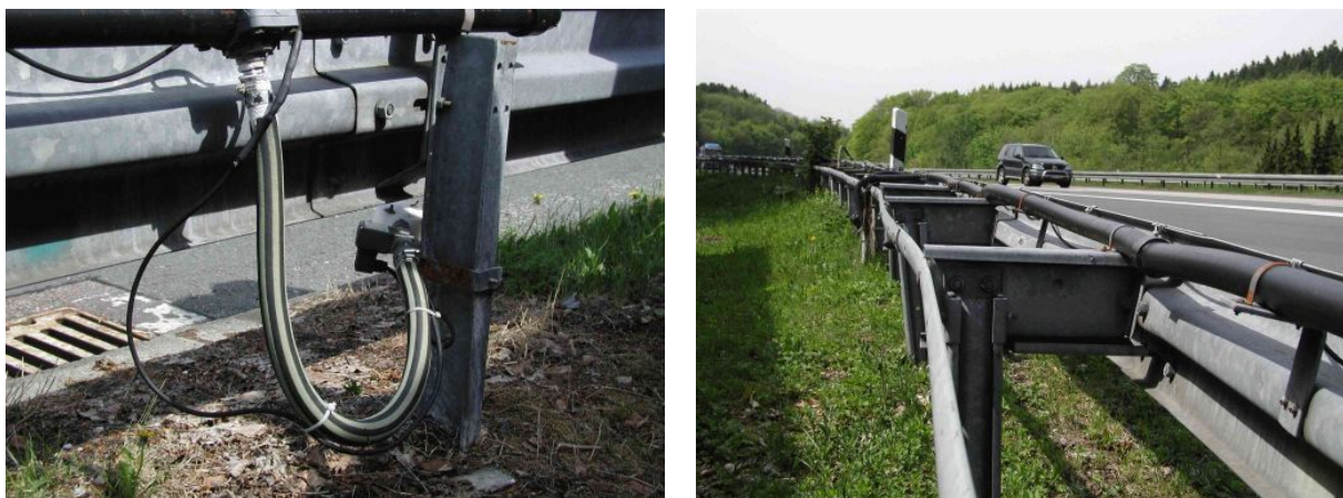
Abbildung 12: Sprühköpfe (links) und Taumittel-Leitungen (rechts) der TMS Lüdenscheid (Fotos: W. Bollinger)
