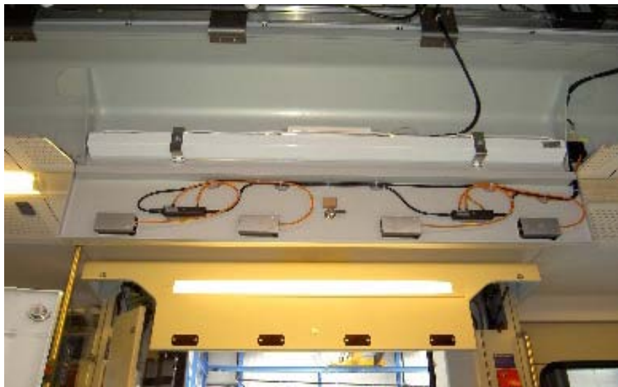
Figure 38 : Système de comptage par détecteurs infrarouges (Source : CFF SA [60])
