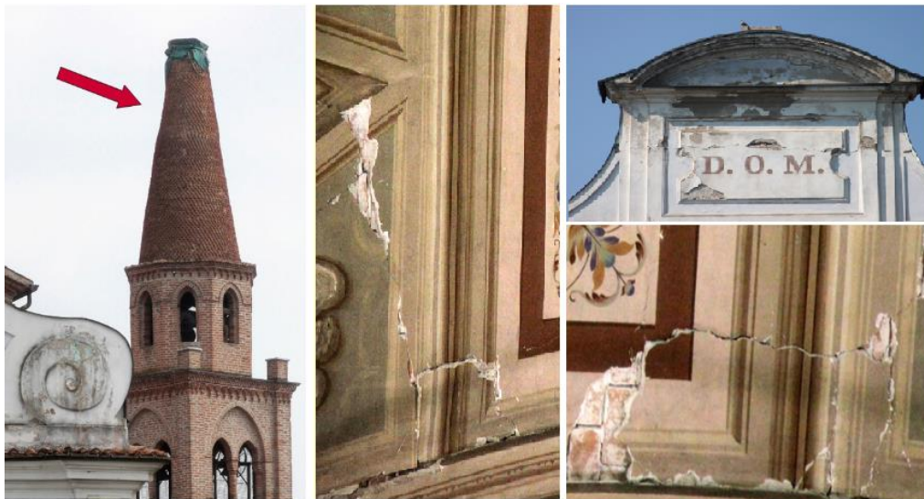
Abb. III-24 Schäden an der Kirche Governolo durch das Erdbeben von Mai 2012.
