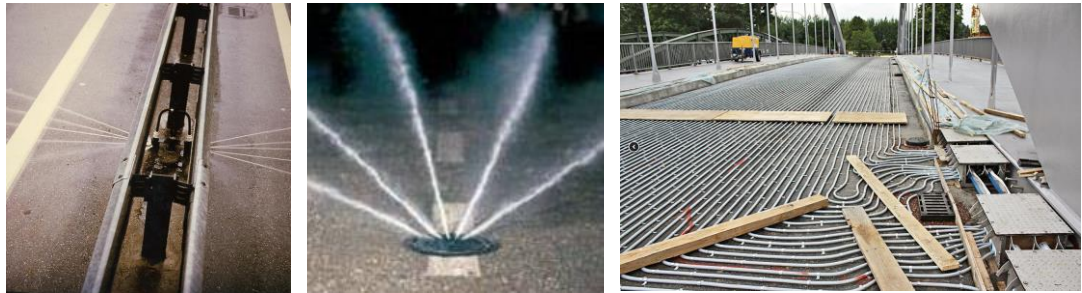
Abbildung 16: Taumittelsprühanlagen und geothermisch beheizte Brücke
