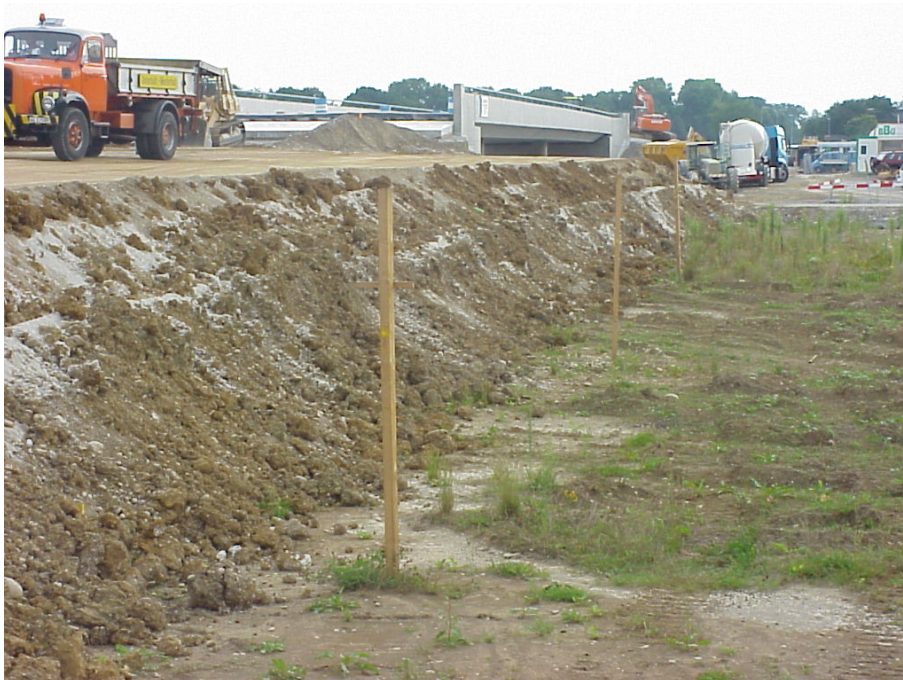
Abbildung A2-10: Dammschüttung in Rheinfelden. Gräulich ist deutlich der beigemischte Kalk zu erkennen. Der Kalk wurde beigegeben, weil die erforderlichen M_E -Werte nicht erreicht wurden.
