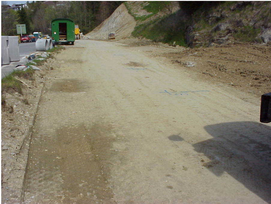
Abbildung A2-1: Prüffläche auf der Dammschüttung der Strassenbaustelle in Teufen. Material siltiger Sand ohne Kies (SM).
