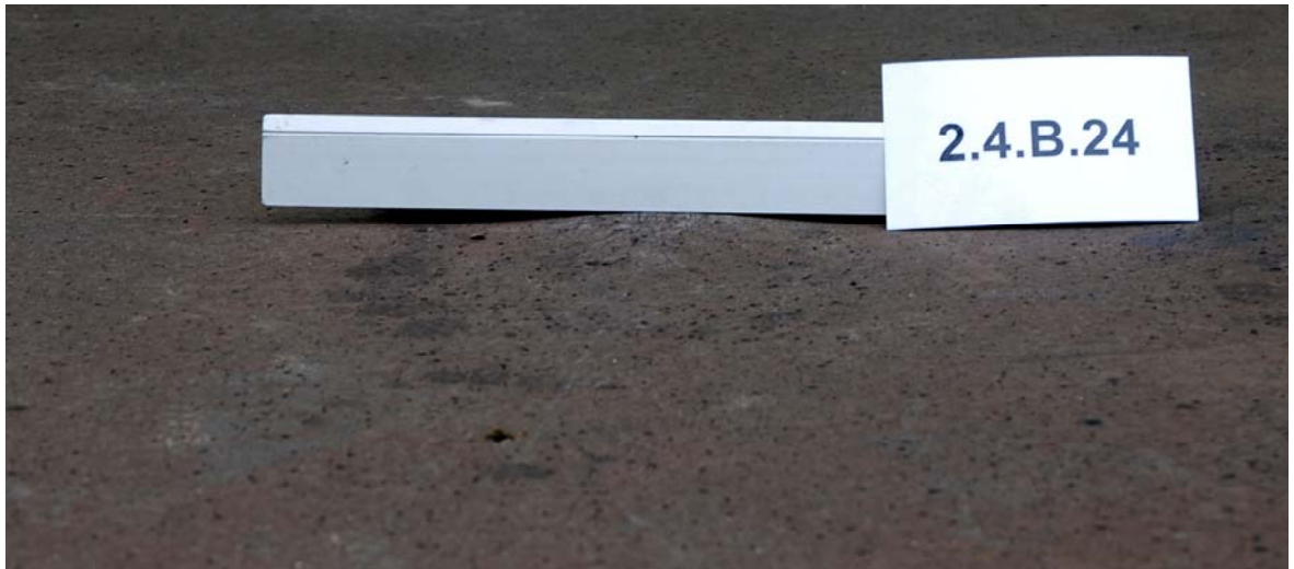
Abb. 68 Foto einer Blase im Feld PMMA-Abdichtung. Die Blasen sind an den Stellen entstanden, an denen die Abdichtung geprüft und nachträglich geflickt wurde
