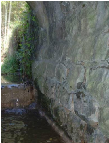
Abb. 7 Deformationen im Wandbereich
