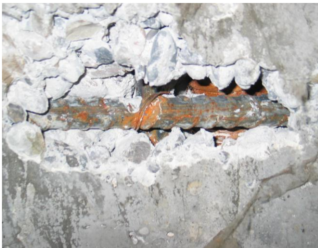
Abb. 17 Hohlstelle mit korrodierte Bewehrung Brücke Süd
