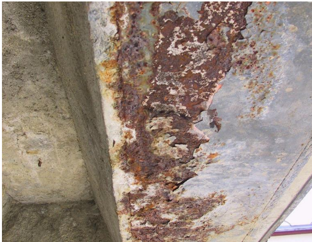
Abb. 24 Grossflächige Korrosion an Träger 1
