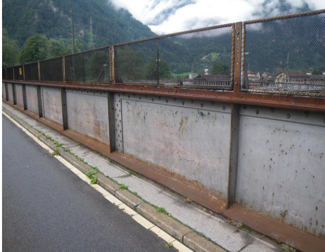
Abb. 12 Oberflächenkorrosion der Längsträger
