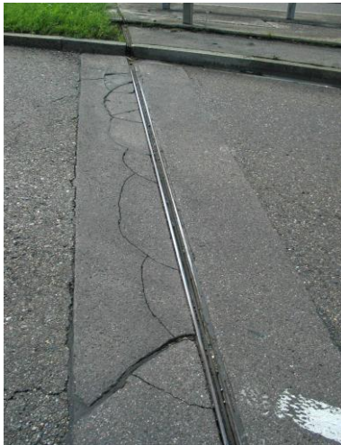
Abb. 16 Gerissener Abdichtungsstreifen bei Fahrbahnübergang
