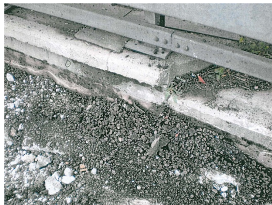
Abb. 4.77 Übergang Unterführung/ Trassee: hochgezogene Bitu- men-Dichtungsbahn mit Jute- Trägereinlage, vollflächig ver- klebt, mit Schutzmörtel
