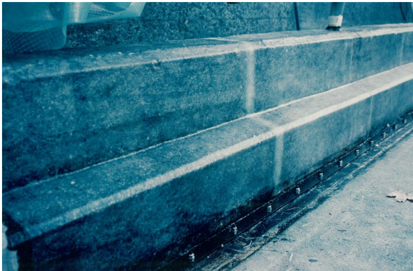
Abb. 4.29 GFK-beschichtete Brüstung, Stahlwinkel einbetoniert und PBD-Streifen verlegt, Fahrbahnplatte bereit für Applikation der PBD-Abdichtung
