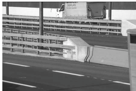
Bild 16, System vor dem Baregg tunnel, A1, Kanton Aargau, mit Übergangskonstruktion
