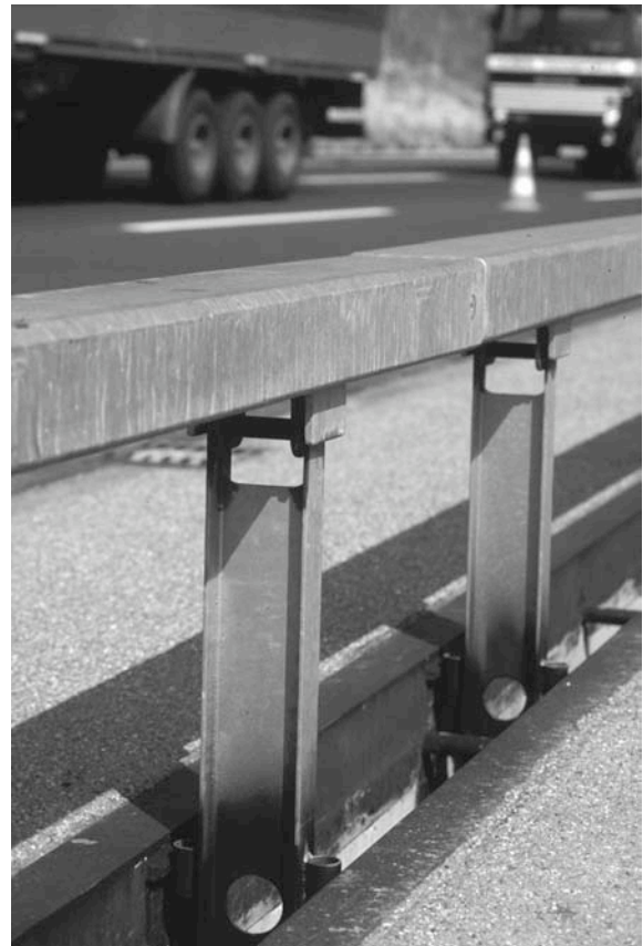
Bild 18, System Burri mit gelenkig befestigten Pfosten, vor dem Gurbristtunnel, A20, Kanton Zürich (Aufnahme 1985)
