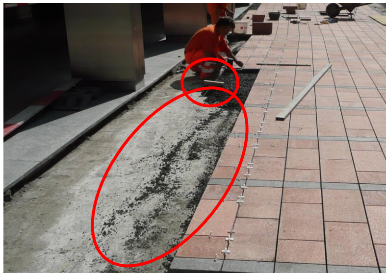
Abb. 12 Wird vor dem Aufbringen des frischen Monokornbetons der erhärtete, im vorderen linken Bildbereich gekennzeichnete Monokornbeton nicht entfernt, sowie auch die losen Körner, dann ist in diesem Bereich nur eine geringe bzw. keine Bindung vorhanden.
