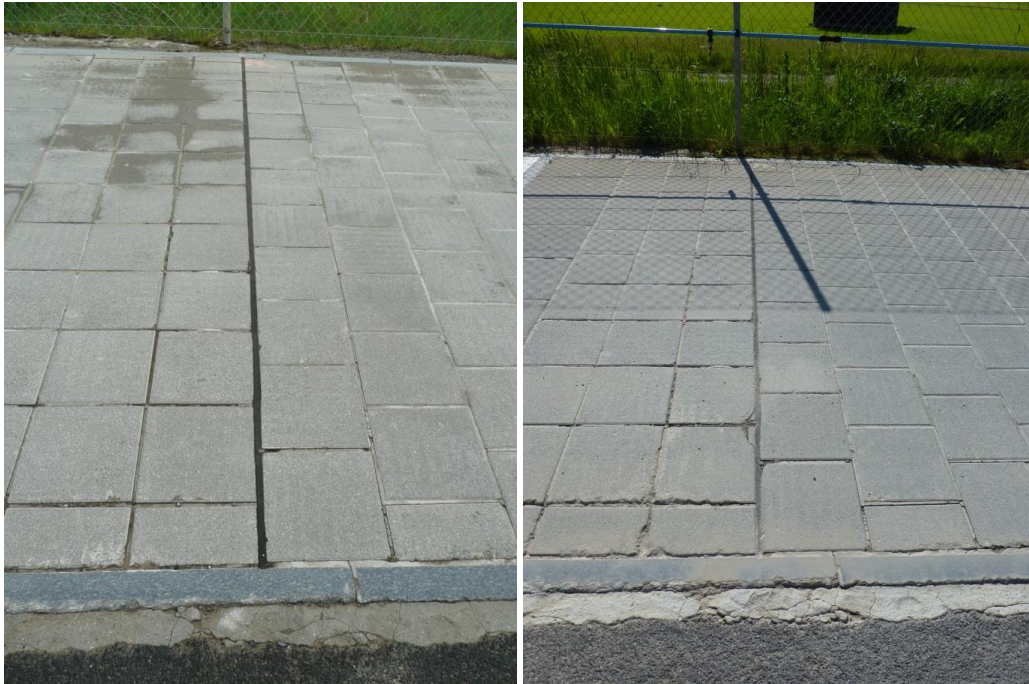
Abb. 145 und Abb. 146 Bewegungsfuge 7, vom 09.05.12 und 28.05.2013
