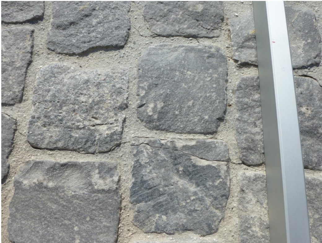
Abb. 32 Nahaufnahme vom Riss, der sich in 2 Risse aufteilt
