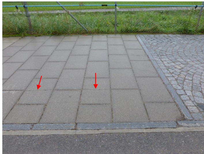
Abb. 11 Im Bereich mit den gebrochenen Platten sind Raupenspuren von der mobilen Brechanlage sichtbar. Aus diesem Grund kann dieses Rissbild nicht beurteilt werden.
