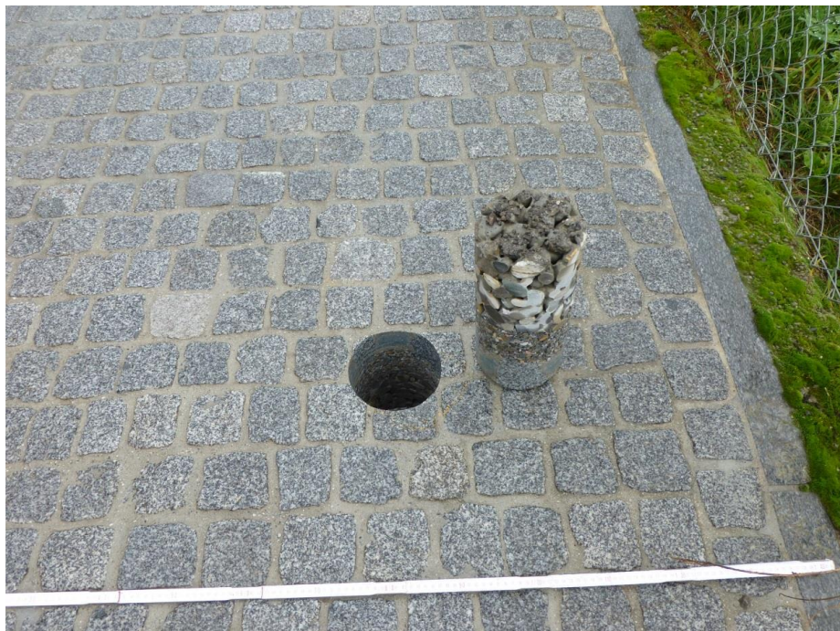
Abb. 47 Feld 8.1.1, am 30.09.2013, Bohrkern 8.1.1.2
