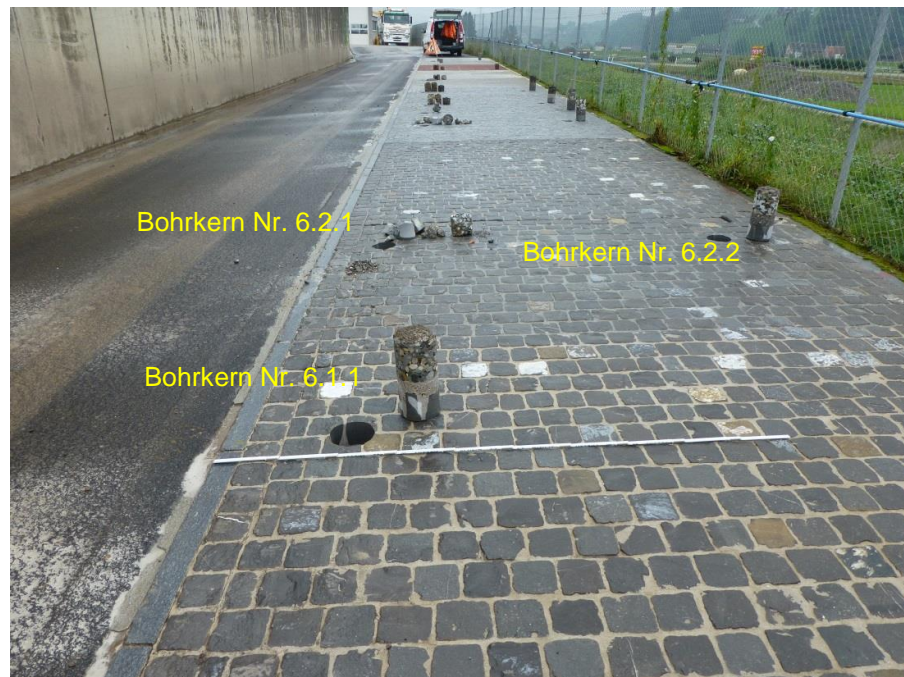
Abb. 25 Im Feld 6.1 wurde im Fahrbahnbereich links, in der Fläche ohne Risse, ein Bohrkern entnommen.
