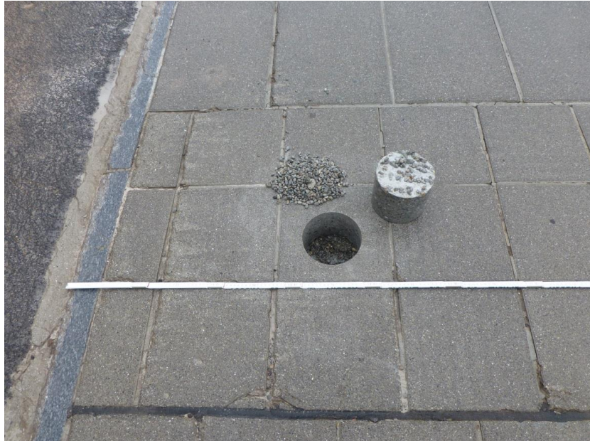
Abb. 118 Feld 11, am 30.09.2013, Bohrkern 11.2
