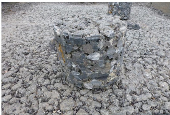
Abb. 10 Auf dem Foto ist die Verzahnung zwischen der gebundenen wasserdurchlässigen Tragschicht und dem Splitt als Bettungsmaterial deutlich zu erkennen. Voraussetzung, dass diese Verzahnung entsteht, ist eine Drainbetontragschicht ohne Feinteile 0 – 2 mm.
