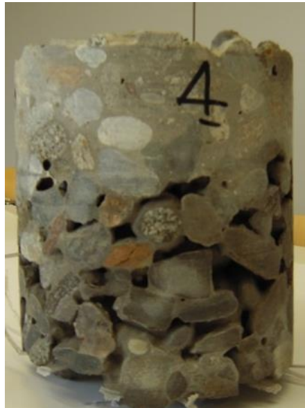
Abb. 21 Foto von Drainbeton mit Feinteilen, wenn durch die vibrierende Verdichten die Feinteile nach oben gesogen werden.
