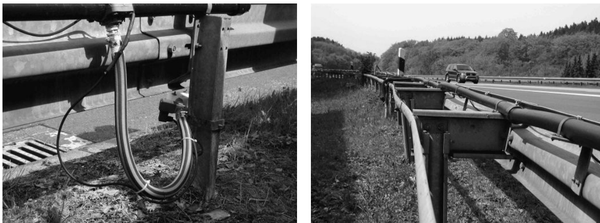
Figure 12 : Tête de giclage (à gauche) et apport de saumure (à droite) de l'IAD de Lüdenscheid (Photos : W. Bollinger)
