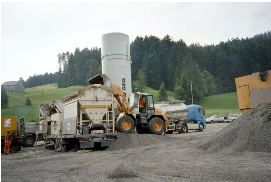
Abbildung 2: Mobile Kaltrecycling-Mischanlage, Wirtgen KMA 220.
