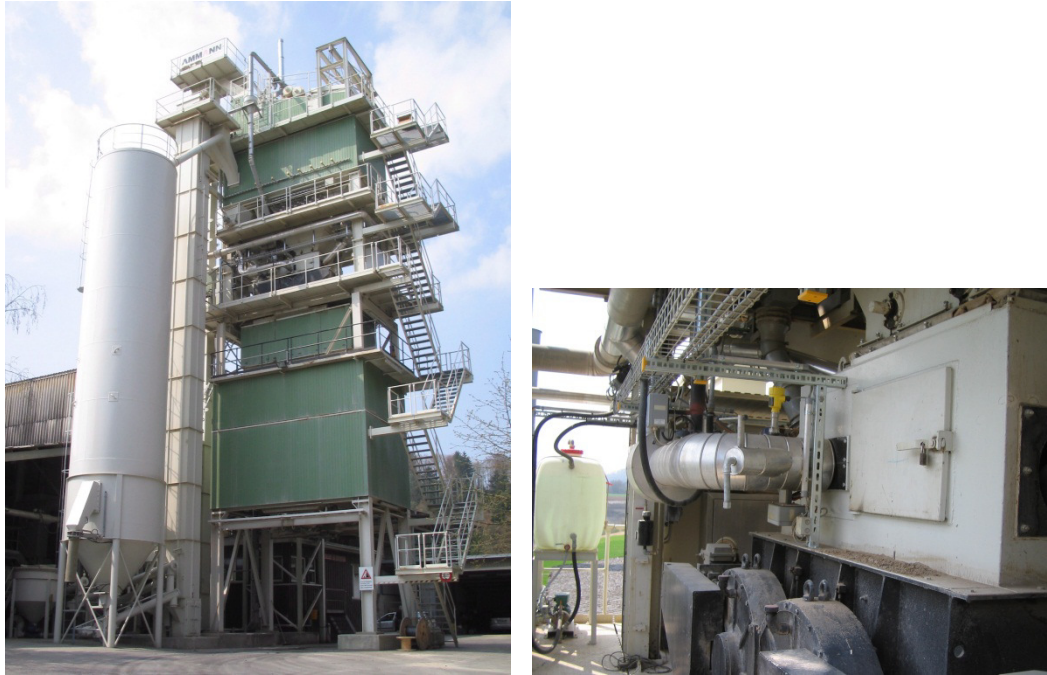
Abbildung 3: Stationäre Anlage mit Schaumbitumeneinheit (Belags AG Böttstein).
