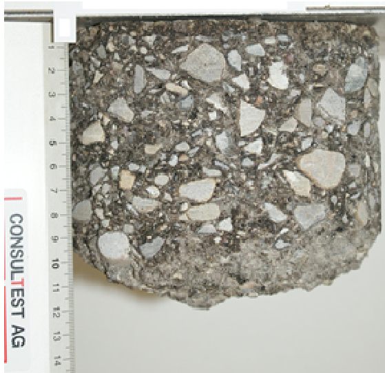
Abbildung 38: Typischer Zustand von KMF-Bohrkern.
