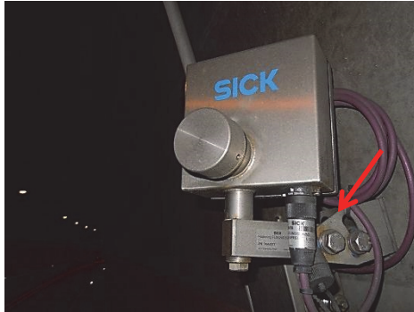
Abb. 4.41 Tunnel Bözberg, SIC – Flugrostspuren auf dem Gehäuse
