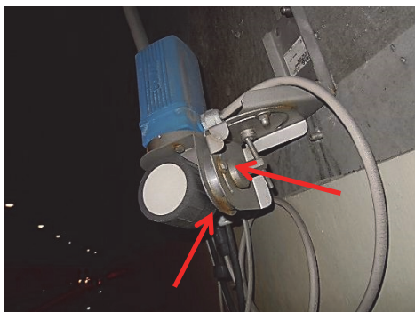
Abb. 4.38 Tunnel Bözberg – DUR, Flugrostspuren an Schweissstellen und Befestigungsteilen (Mutter)
