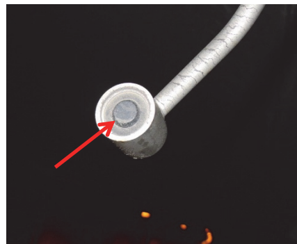
Abb. 4.40 Tunnel Bözberg – FIV, Sensorkopf mit Ablagerungen
