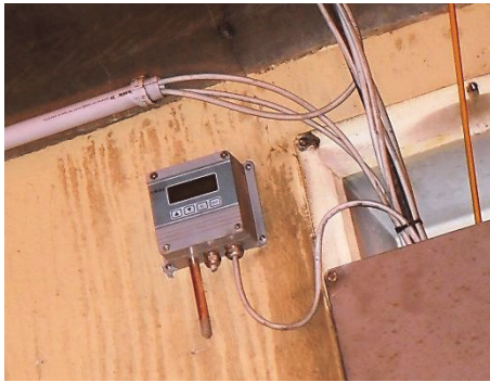
Abb. 3.37 Tunnel Bözberg - Temperatur- und Luftfeuchtemessgerät
