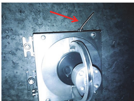
Abb. 4.54 Tunnel Flüelen – COD, abgelenkter Temperaturfühler.
