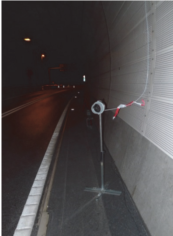
Abb. 5.1 Tunnel Bözberg / Flüelen – Kleinventilator zur Eindüsung des Tracergases
