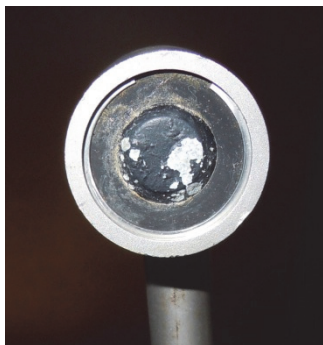
Abb. 4.26 Tunnel Flüelen - 11.09.2012, M1, durch Salzeinwirkung korrodierter Ultraschallsensor
