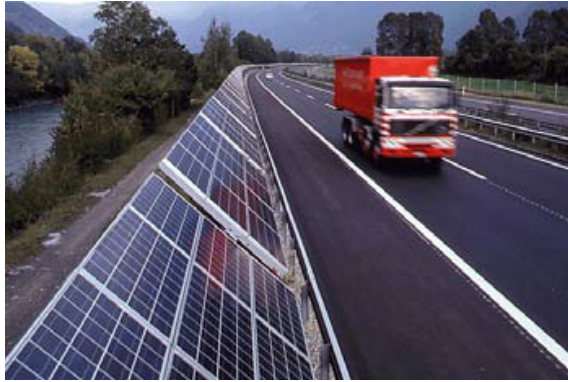
Abb. 7.2: Domat/EMS, PV-Anlage auf bestehende Lärmschutzanlage aufgesetzt
