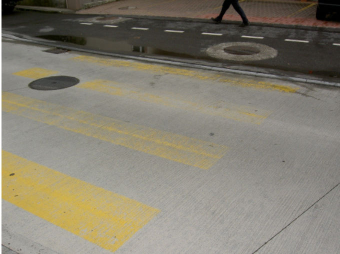
Abb. 4.40 Beispiel für abgenutzte Markierung im Einfahrtsbereich eines Betonkreisels
