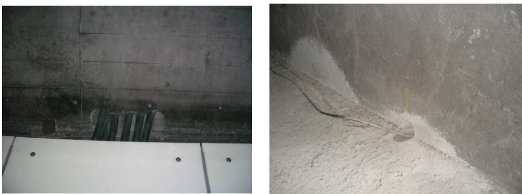
Abbildung 40: Nachträglich erstellte und unverschlossene Kabeldurchführungen
