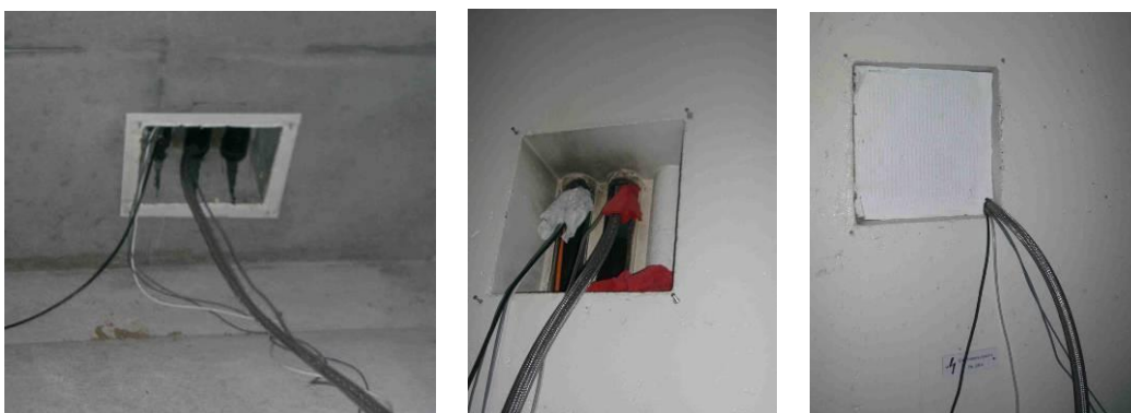
Abbildung 8: Kabel- und Schlauchführung durch die Rundschläge (Tunnel Flimsenstein)
