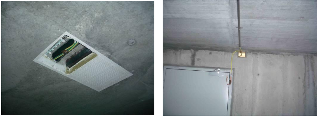
Abbildung 39: links: Aussparung bei Rundschlag mit weggerissener Brandabschottung; rechts: Unverschlossene Kabeldurchführung in den Abluftkanal
