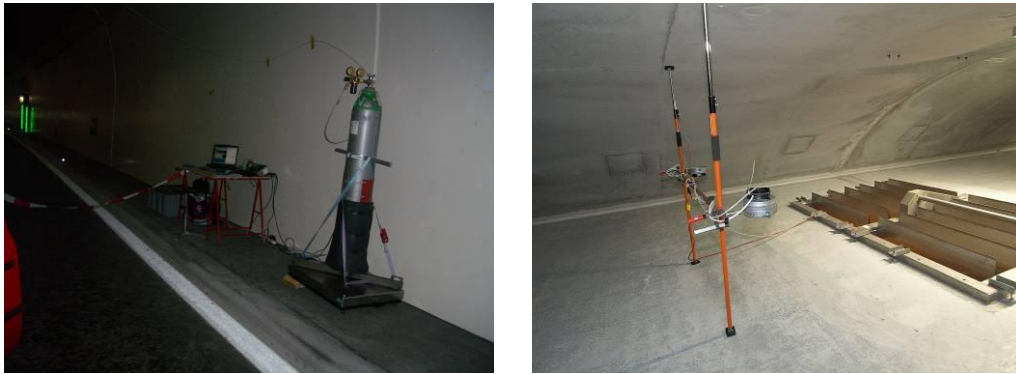
Abbildung 6: Dosierstelle im Fahrraum (links) und im Abluftkanal (rechts)
