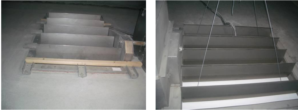
Abbildung 9: Kabel- und Schlauchführung durch offene und mit Brettern verschlossene Abluftklappen (zwei Arten der Befestigung der Bretter: links mit Querhölzern und Gewindestangen, rechts mit Seilen und Anker im Gewölbe)
