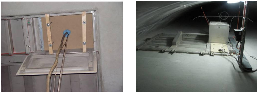
Abbildung 10: Kabel- und Schlauchführung durch Mannlöcher in der Abluftklappe (Westumfahrung Zürich)
