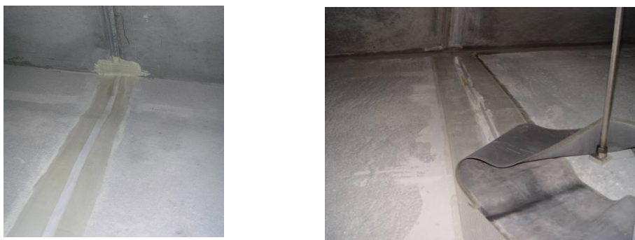
Abbildung 36: Abdichtung der Querfugen mit Dichtungsbändern; links: intaktes Dichtungsband, rechts: gelöstes Dichtungsband (Montagefehler)
