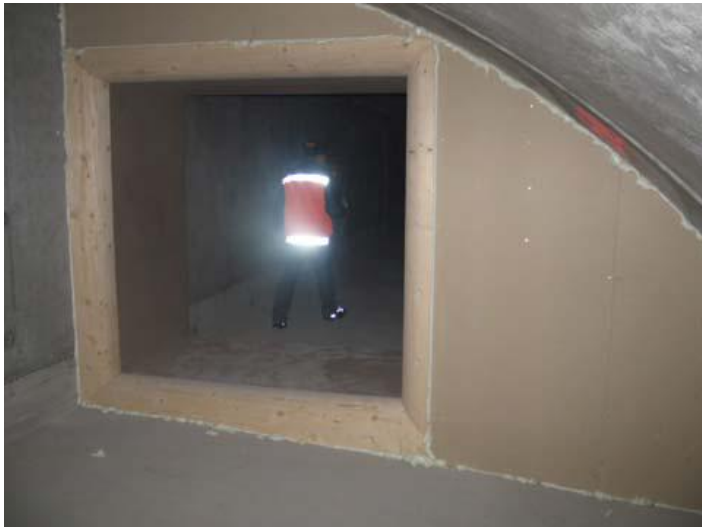
Abbildung 5: Beispiel einer montierten Messdüse im Abluftkanal (Quelle [14])
