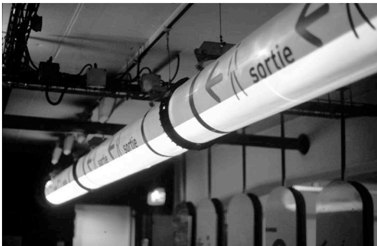
Eindrückliche Signalisierung mit gasgefülltem Leuchtrohr
