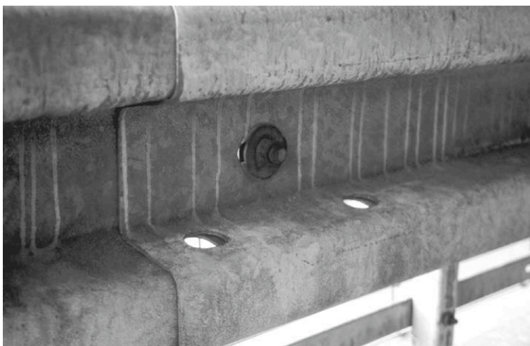
Leitschranke ohne zugfeste Verbindung der Planke - wenig wirksame Absturz-sicherung
