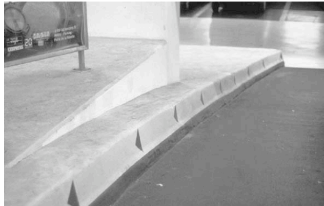
Abbildung 3: Leitbord an Rampe gegen Anprall
