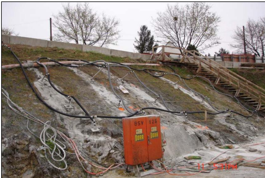
Abb. 2.16 Testanlage mit Energieankern in einer Böschungssicherung (Lainzerberg Tunnel, LT31 Klimtgasse, Wien) [9]
