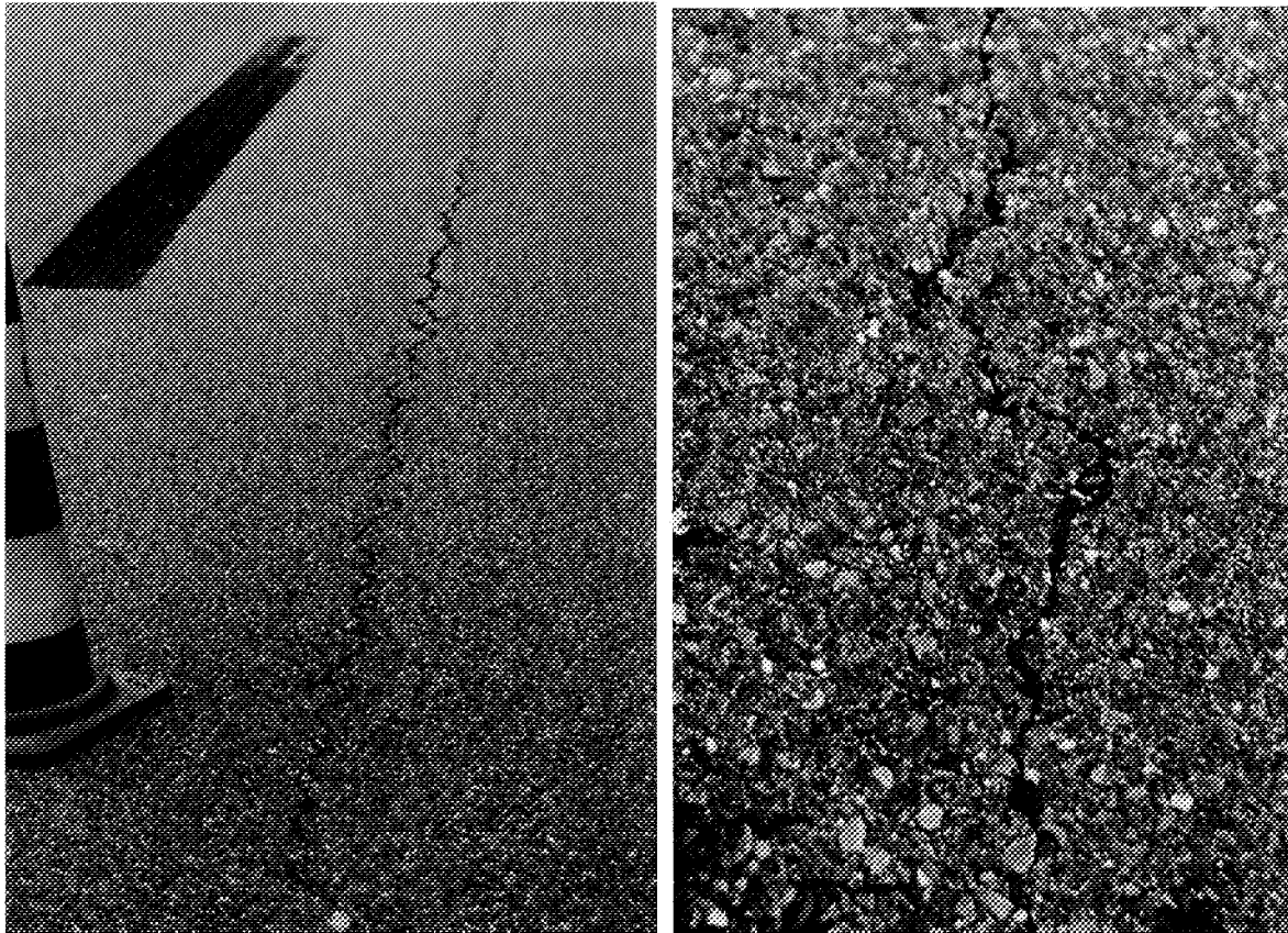
Abbildung 4.2.4: Zustand vor der Sanierung, K4
