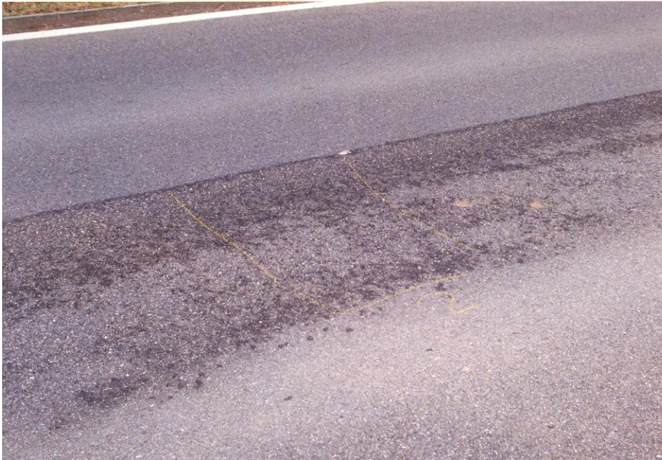
Abbildung 8: Unten: Belag mit Kornausbruch, oben: intakte Gegenfahrbahn
