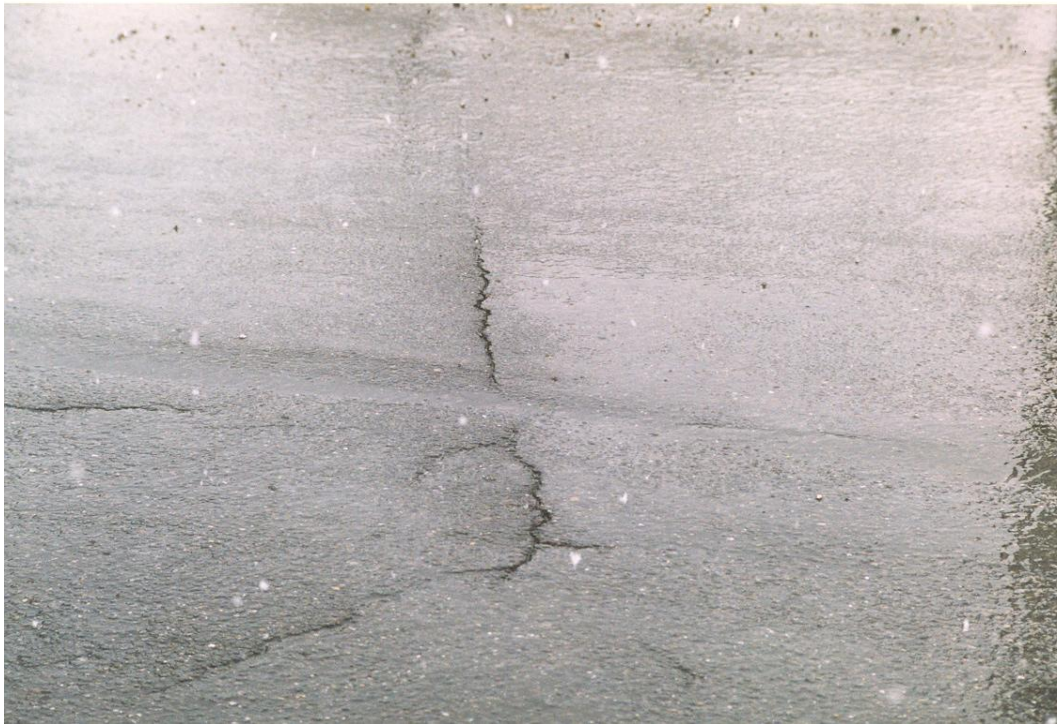
Abbildung 31: Risse in der Deckschicht
