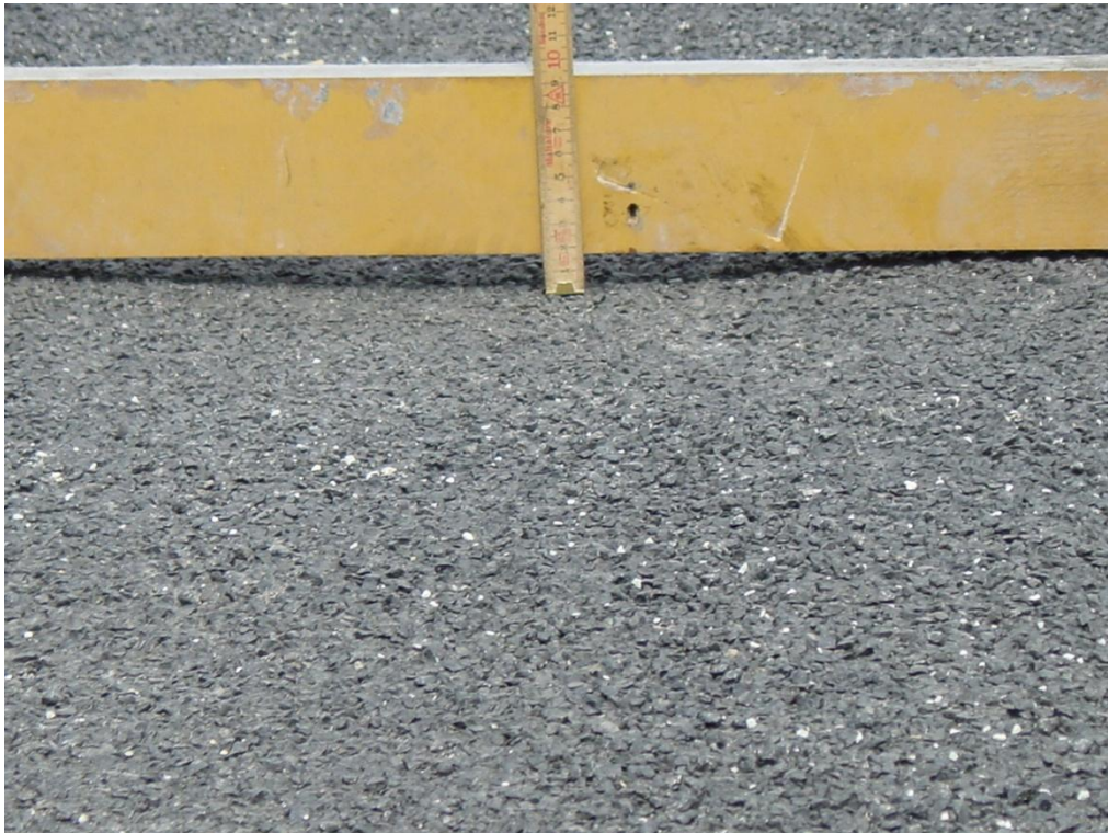
Abbildung 13: Spurrinnen bei frisch hergestelltem Gussasphalt des Objektes AG2
