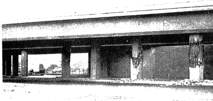
Fig.5.19. Rupture des colonnes de la ligne d'appui no. 3 du passage inférieur du Boulevard de Foothill. San Fernando (1971).
