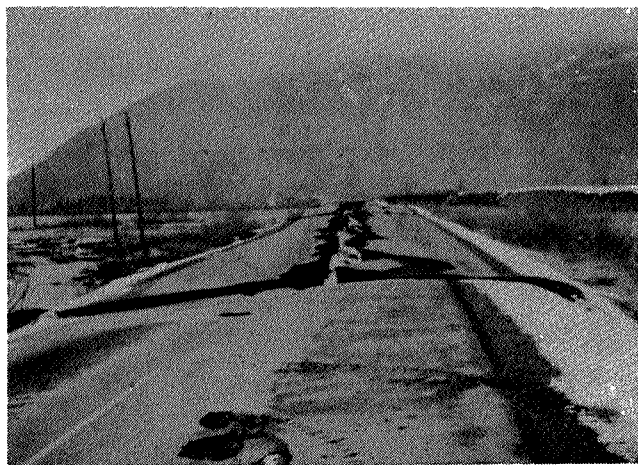
Fig.1.3. Dégâts causés à la route Anchorage-Portage. Alaska (1964). D'après Seed (1970).
