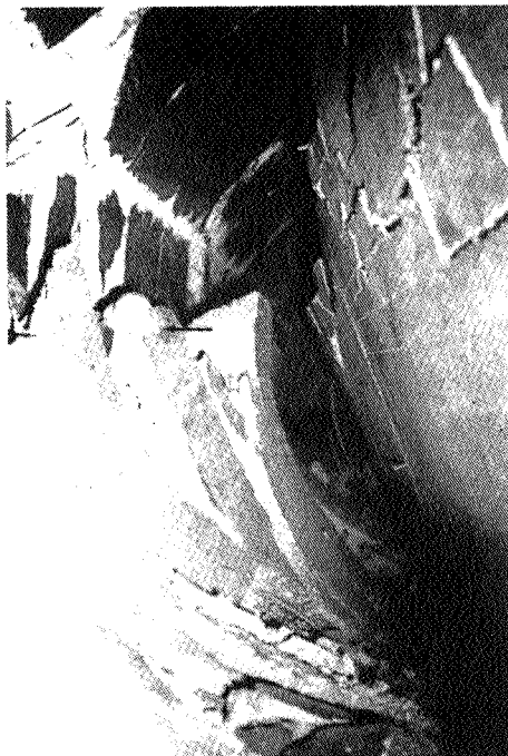
Fig.4.1. Destruction d'un tunnel de chemin de fer provoquée par une faille. Kern County (1952).
