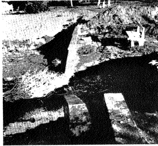
Fig.3.2. Déplacement d'un mur de soutènement. Chili (1960).
