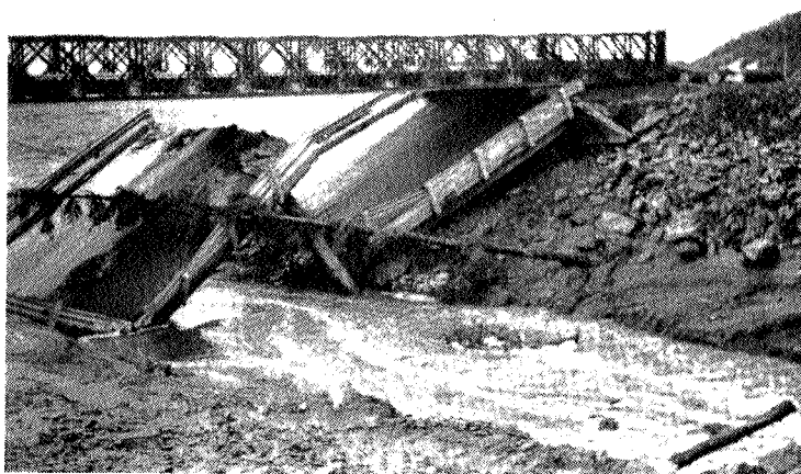
Fig.5.9. Effondrement d'un tablier de pont. Alaska (1964).
